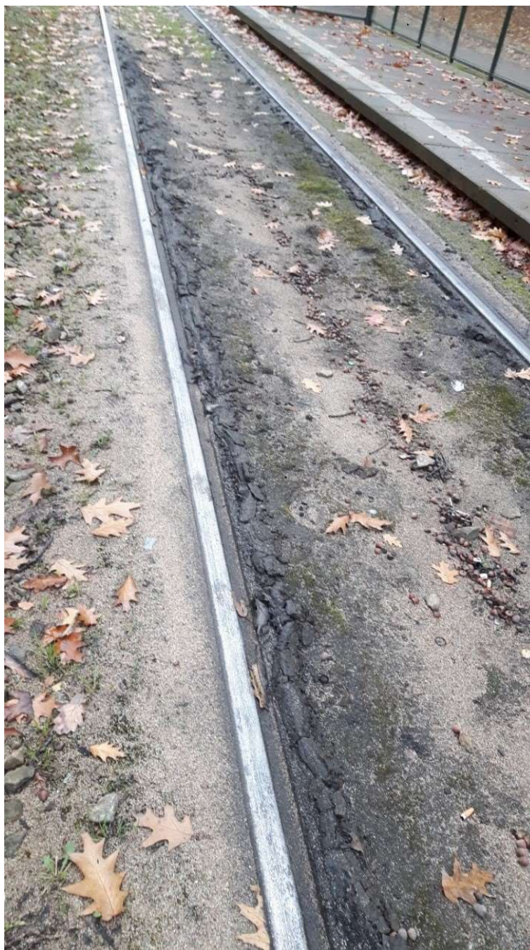
Rys. 8.5.3. Zanieczyszczenie podsypki drobnymi frakcjami pochodzącymi z piasecznic tramwajów
