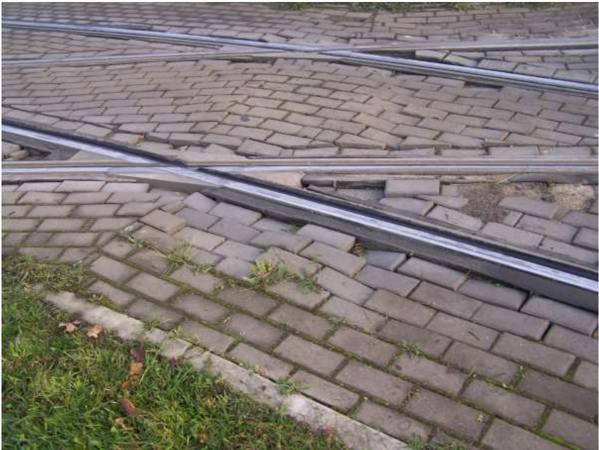
Rys. 7.2.3. Przykład uszkodzenia strefy przyszynowej w przejeździe z kostki betonowej
