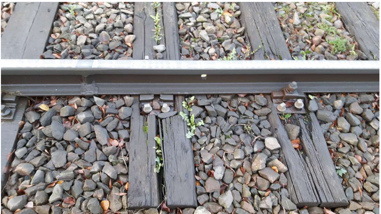
Rys. 8.3.2. Podłużne pęknięcia podkładów drewnianych
