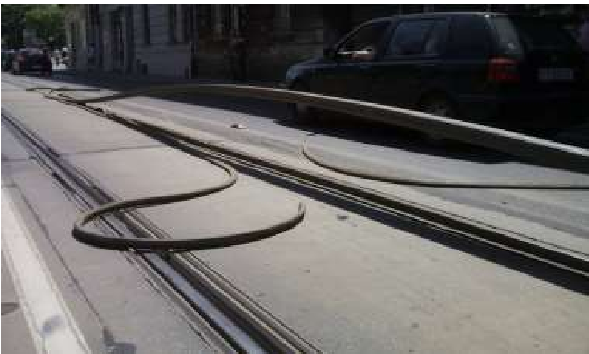
Rys. 5.3. Przykład pionowego wyboczenia szyny blokowej LK1 w torowisku węgierskim
