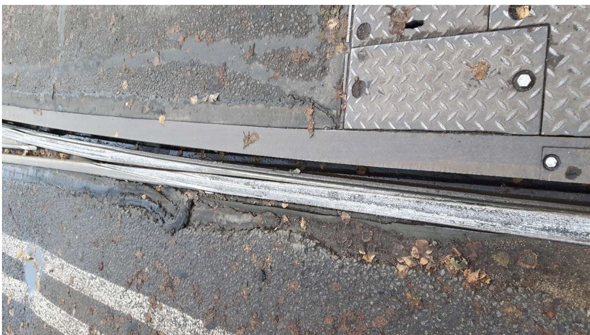
Rys. 8.2.5. Zużycie boczne iglicy oraz pionowe opornicy rozjazdu eksploatowanego asymetrycznie
