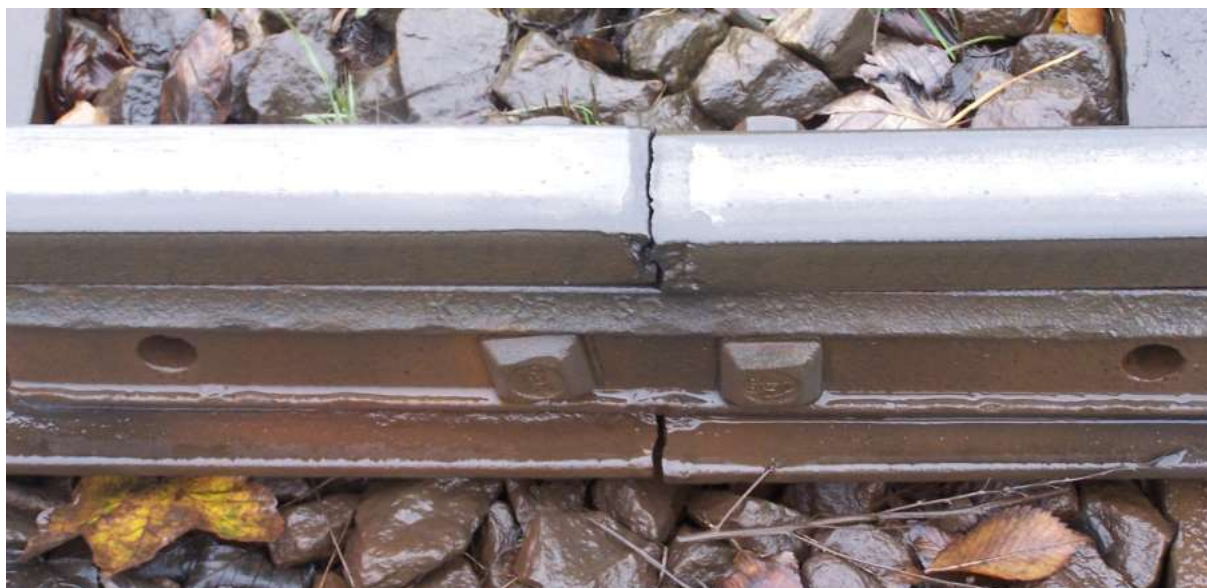
Rys. 5.1. Szyna pęknięta w czasie niskich temperatur
