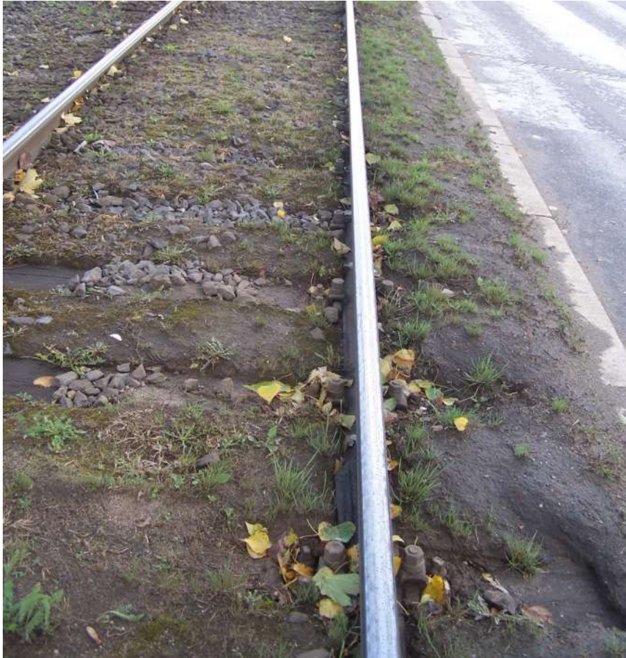
Rys. 11.4.1. Bardzo duże zanieczyszczenie podsypki i wychlapki spowodowane spychaniem zanieczyszczeń w czasie odśnieżania
