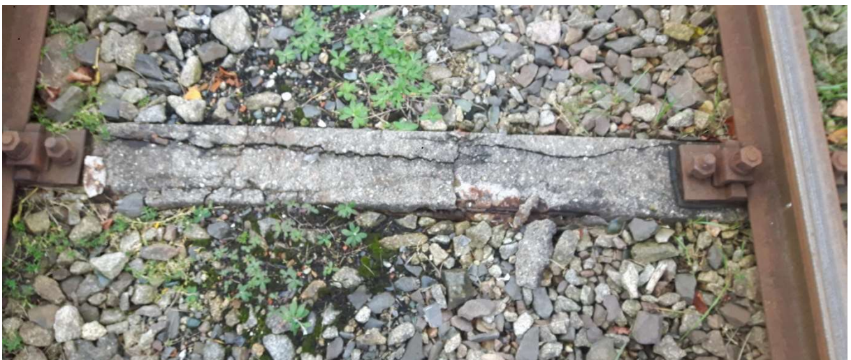
Rys. 8.3.3. Podłużne pęknięcia podkładów betonowych
