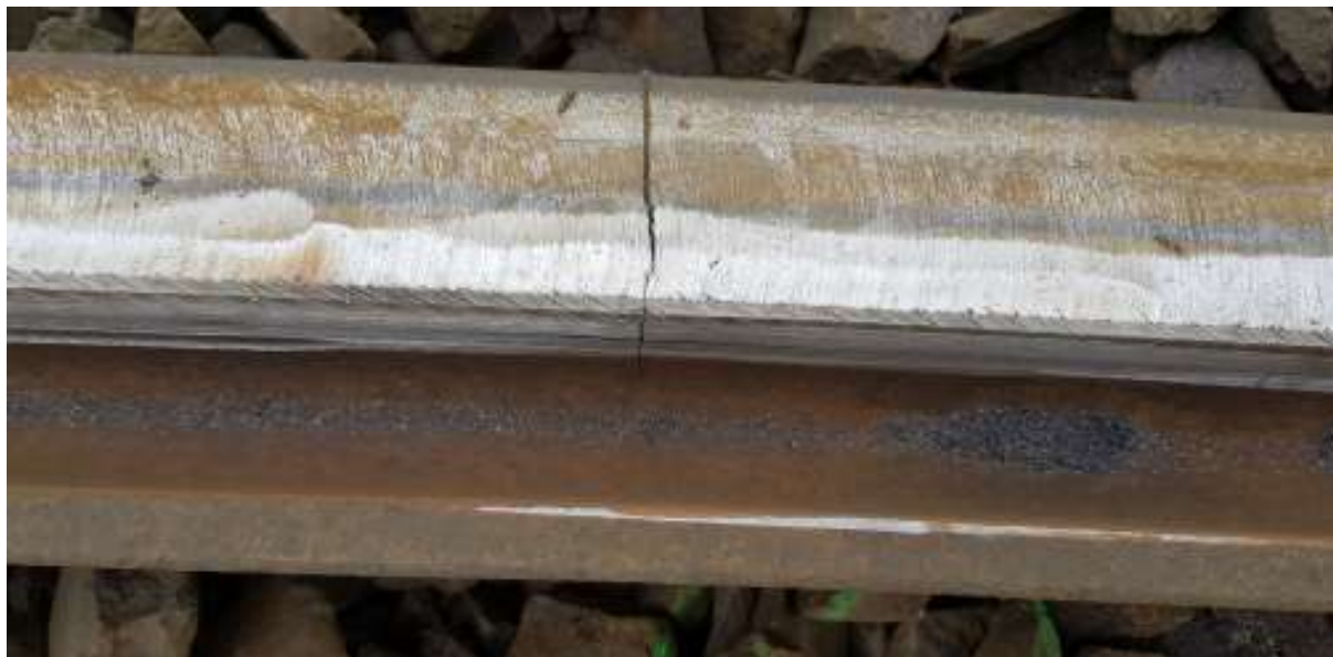
Rys. 11.2.4. Pęknięcie główki szyny
