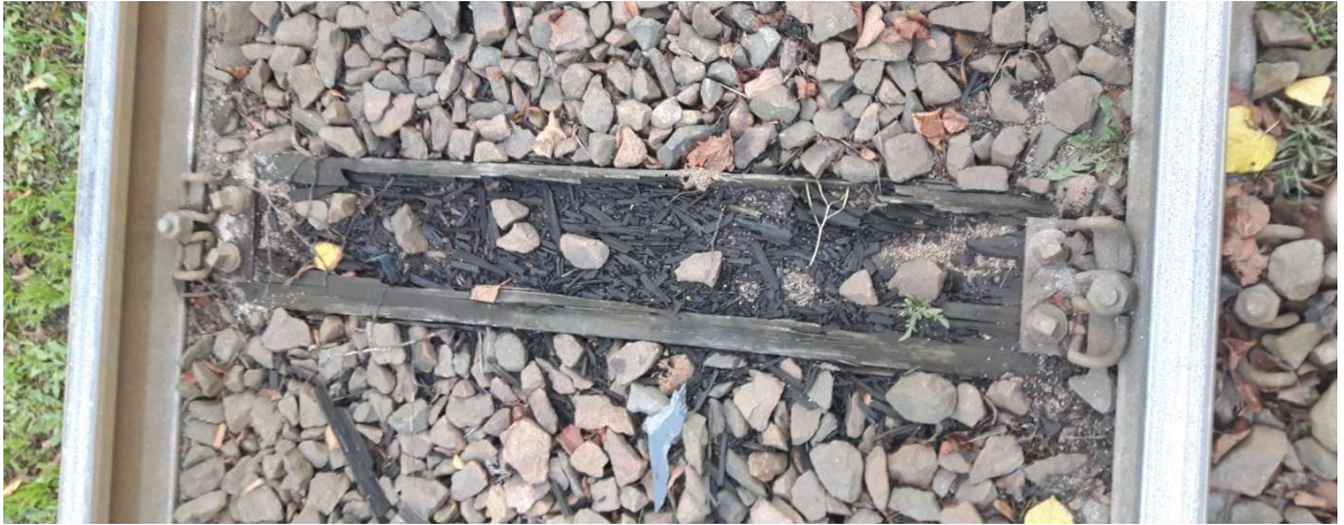
Rys. 8.3.1. Ślady murszu na podkładzie drewnianym
