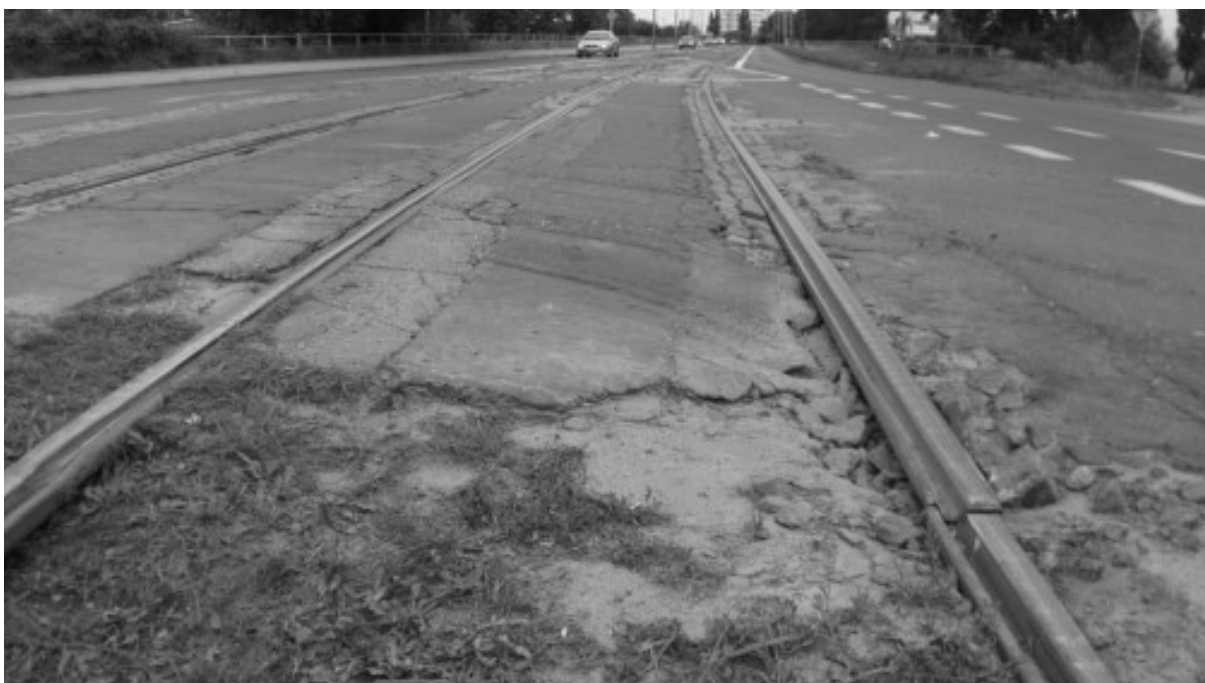
Rys. 7.2.2. Przykład bardzo złego stanu technicznego przejazdu/toru wspólnego z jezdnią (pęknięta szyna i wychłapy)
