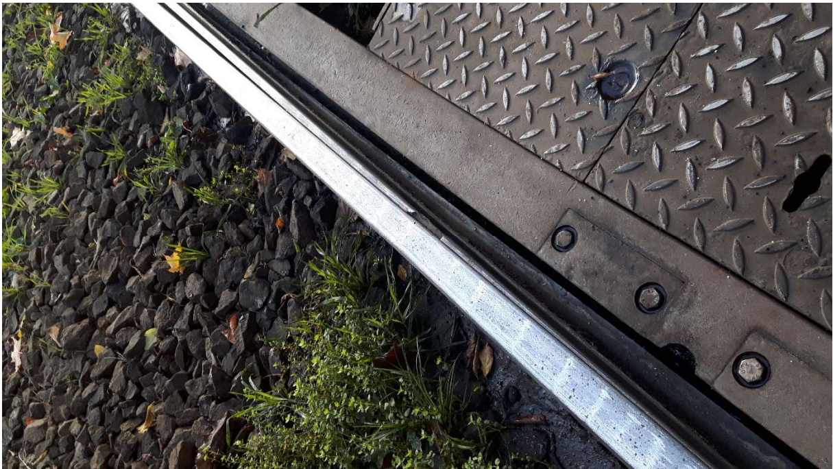
Rys. 8.2.6. Wyszczerbienie iglicy rozjazdu
