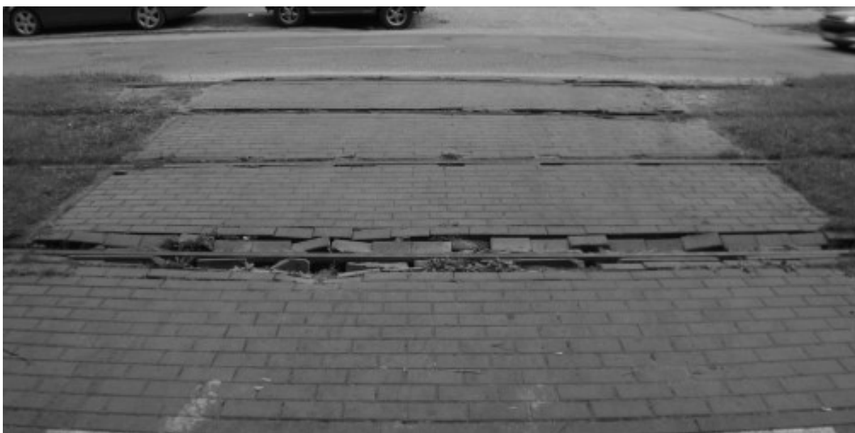
Rys. 7.2.1. Przykład uszkodzenia strefy przyszynowej w przejeździe z kostki betonowej
