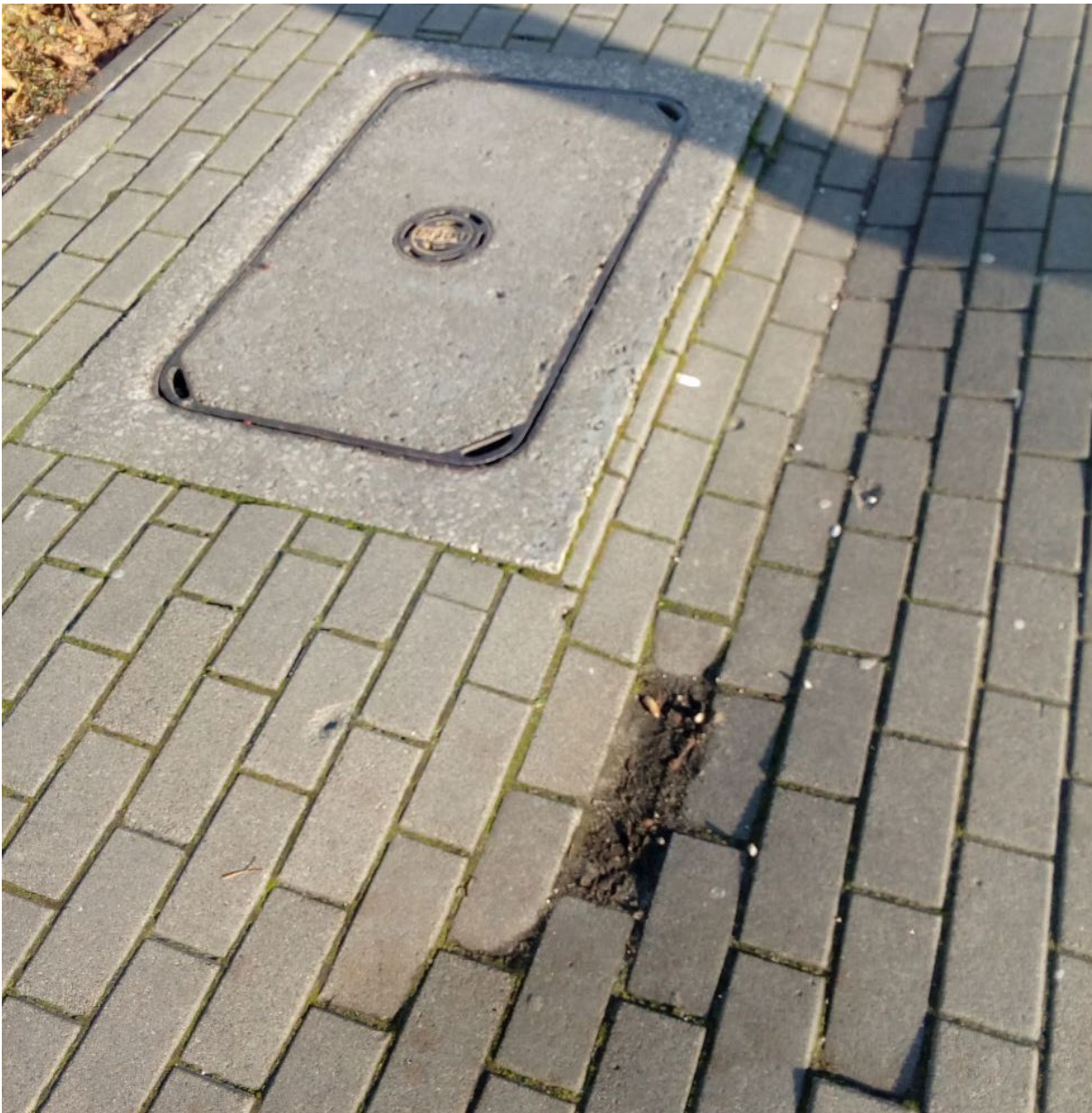
Rys. 6.5. Zapadnięcia lokalne bez ubytków
