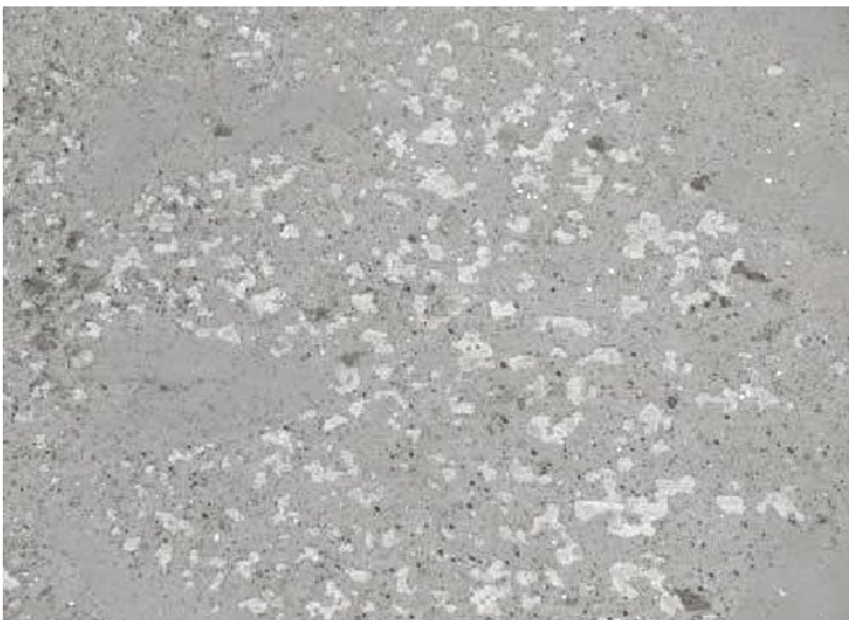
Rys. 5.2.3.10. Widok ubytków ziaren/lejków
