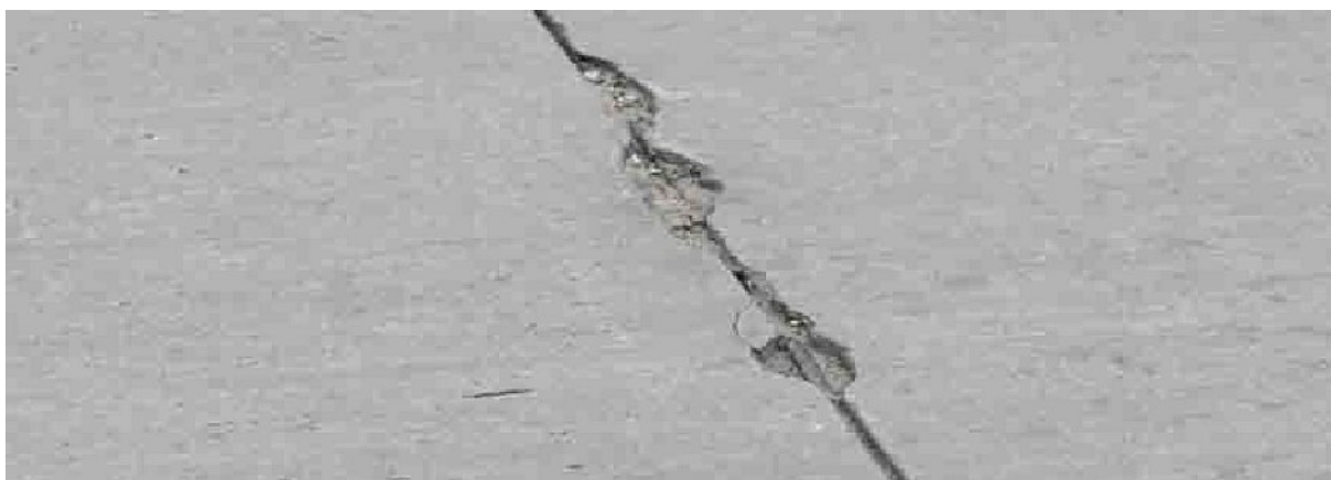
Rys. 5.2.4.1. Widok uszkodzenia szczeliny płyty
