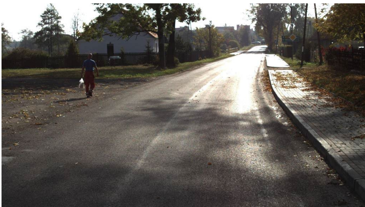
Rys. 5.1.1.4. Stan niezadowalający: widoczna deformacja w śladzie prawego koła – uszkodzenia zajmujące powyżej 10% powierzchni [6]
