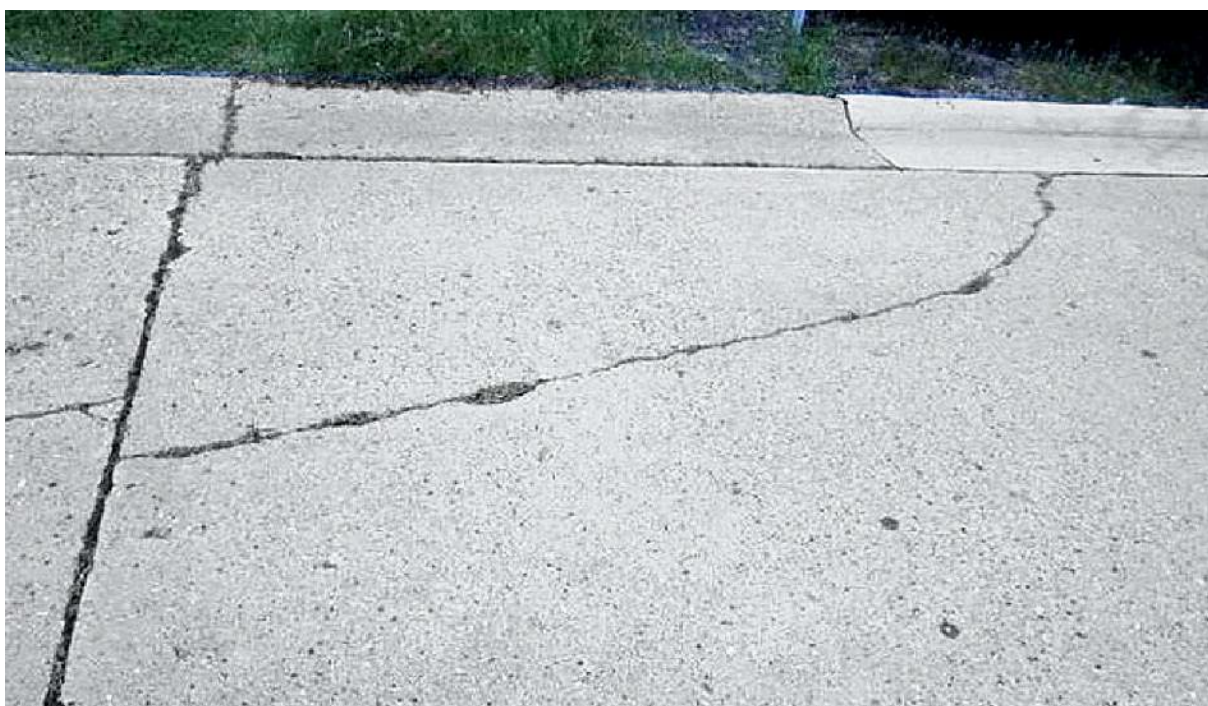
Rys. 5.2.2.7. Widok pęknięcia naroża z częściowym wykruszeniem
