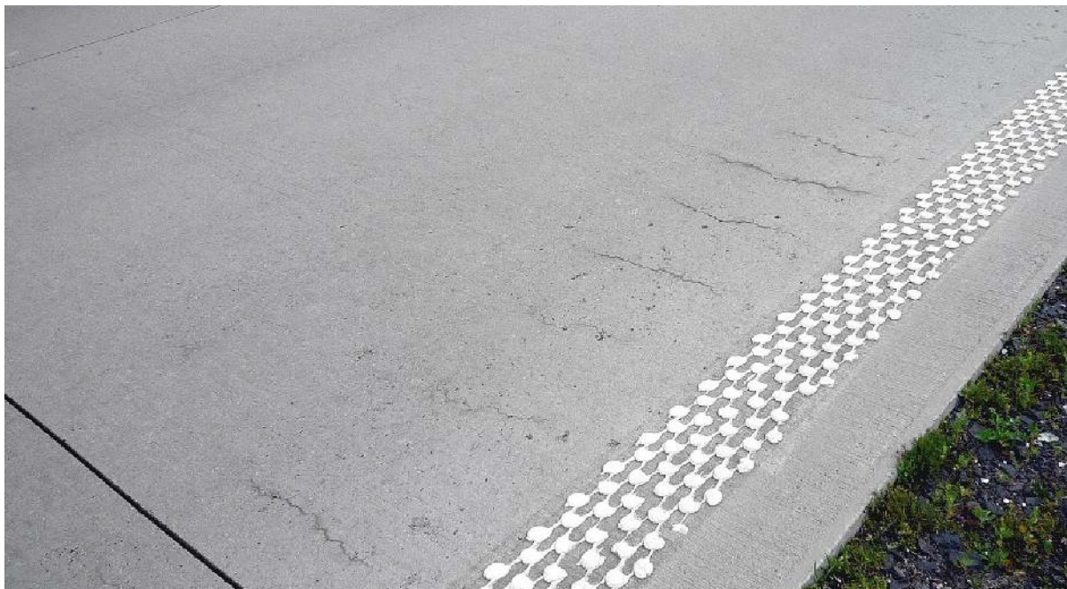
Rys. 5.2.3.7. Widok pęknięć spowodowane niewłaściwą pielęgnacją
