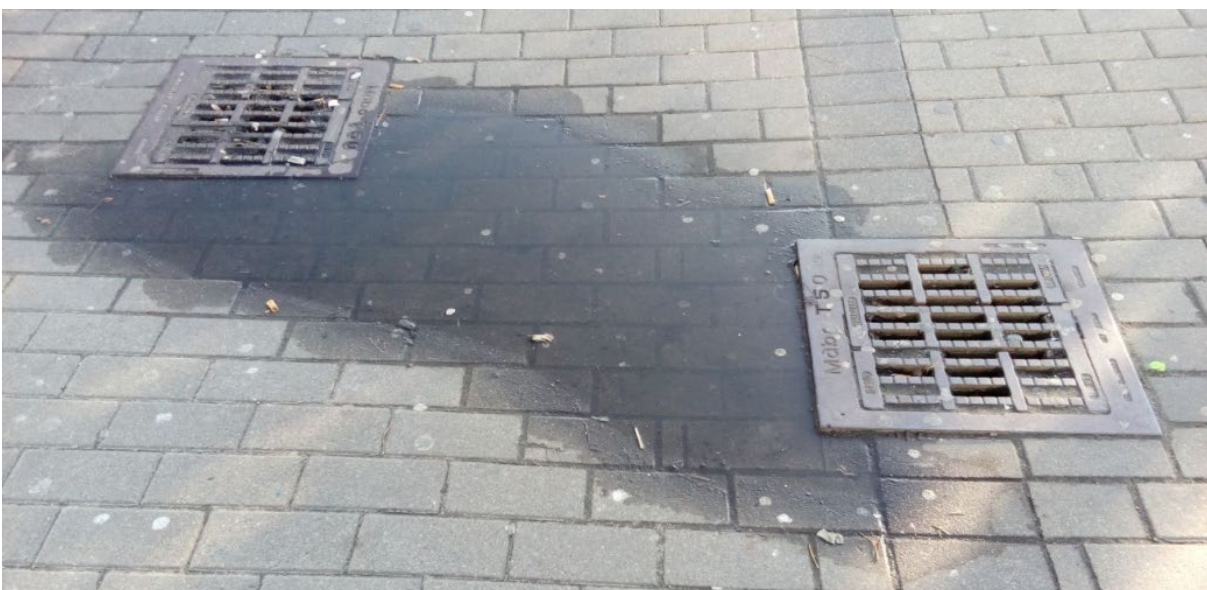
Rys. 6.6. Zapadnięcia lokalne bez ubytków
