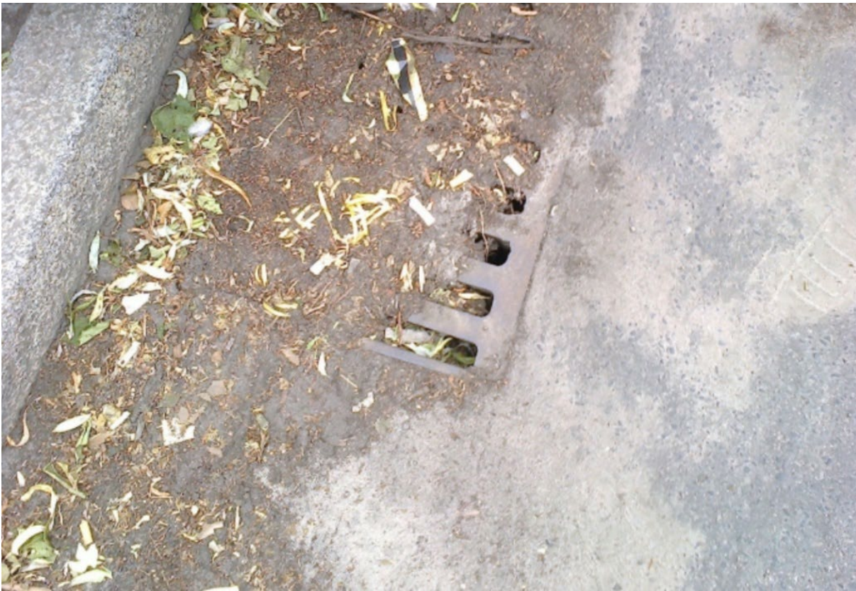
Rys. 7.2.5. Wpusty studzienek kanalizacyjnych i studzienki zasypane – stan zły
