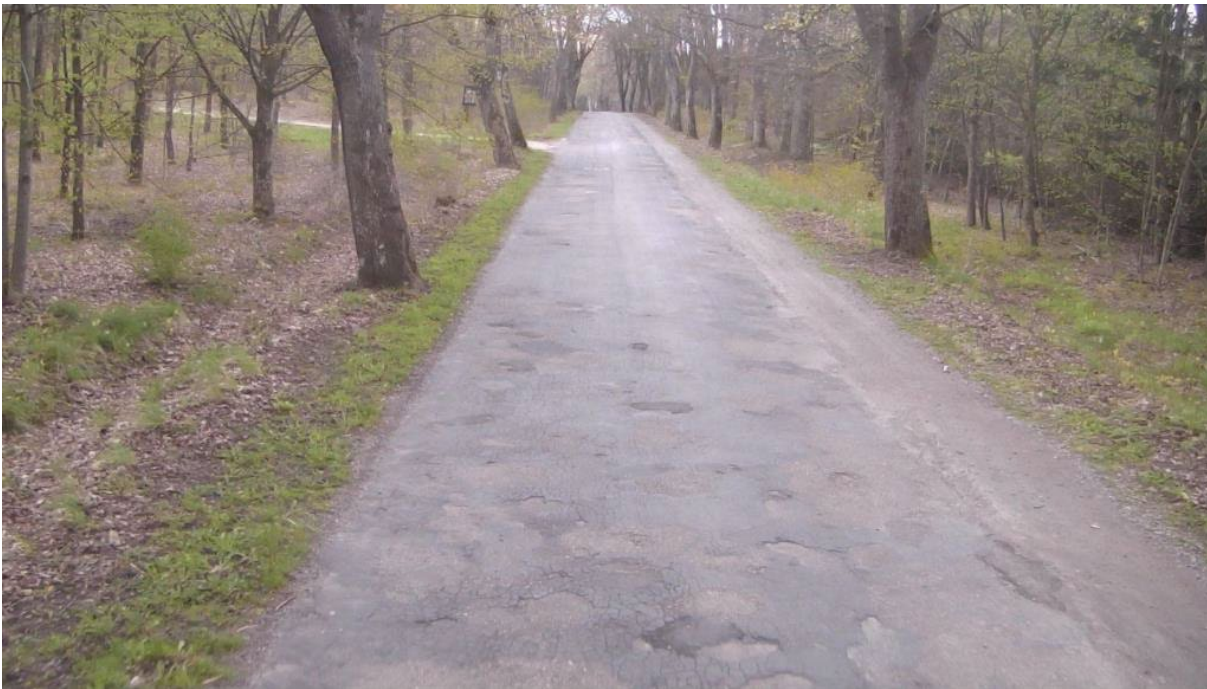
Rys. 5.1.3.7. Stan zły: liczne wyboje – powyżej 50% powierzchni [6]
