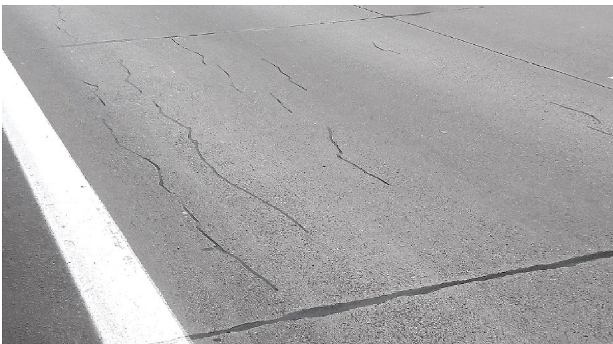
Rys. 5.2.2.2. Widok krótkich pęknięć podłużnych
