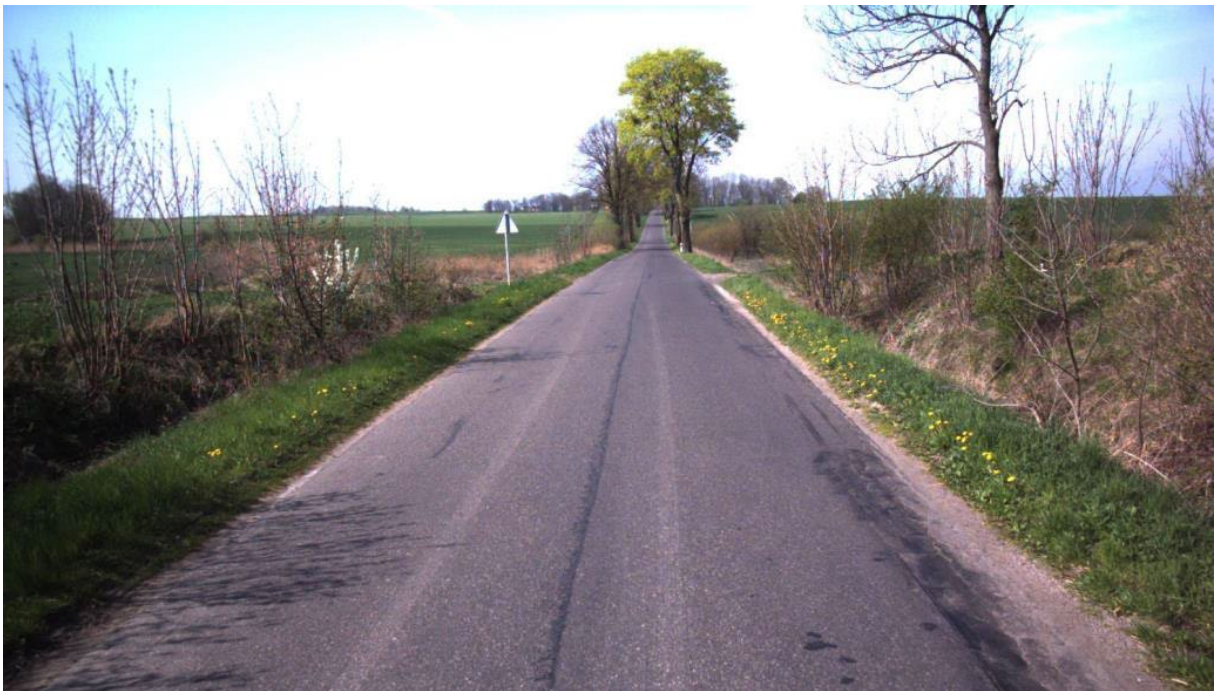
Rys. 5.1.3.6. Stan niezadowalający: łaty oraz spękania zajmujące do 20% powierzchni [6]
