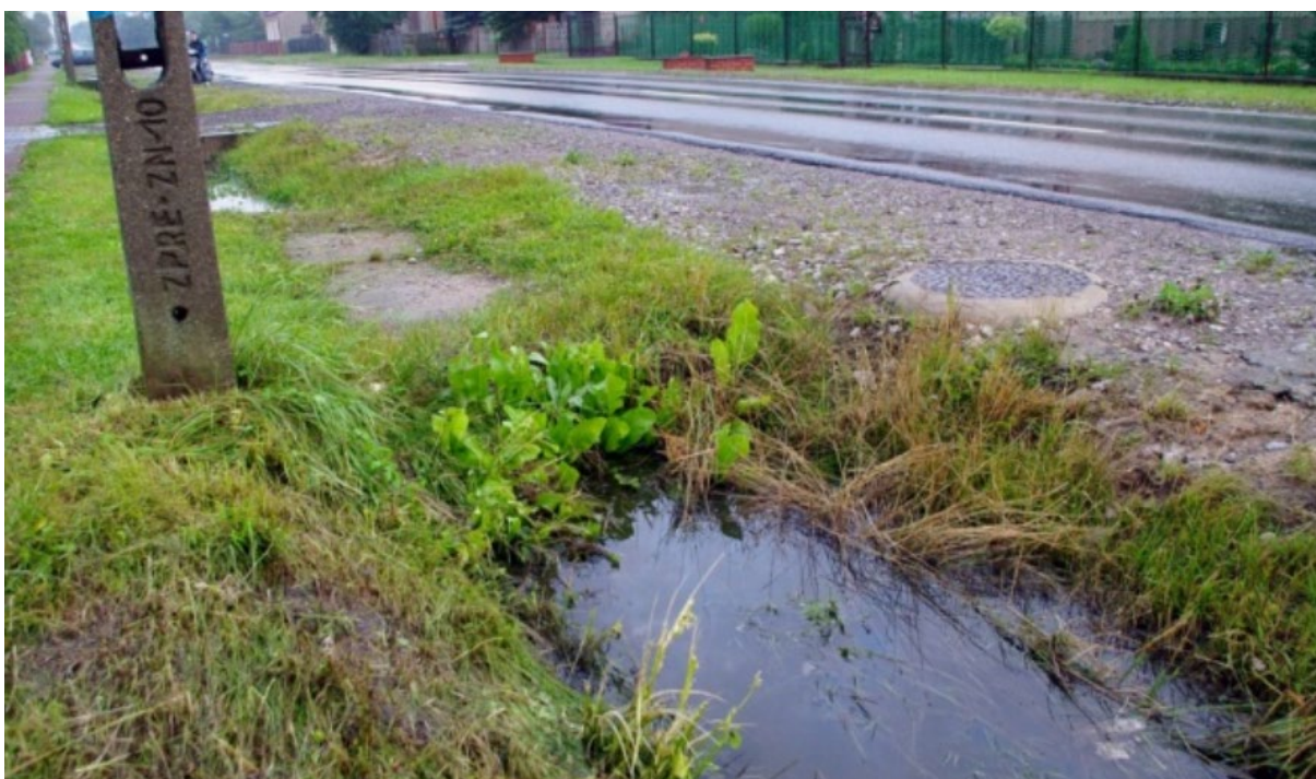
Rys. 7.2.2. Brak odpływu wody, elementy odwodnień zasypane – stan zły
