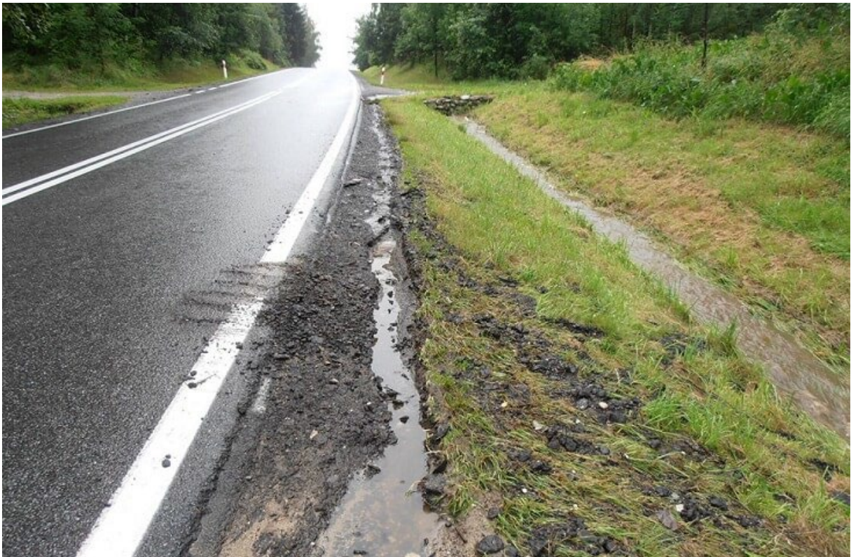
Rys. 7.1.2. Pobocze „skoleinowane” drugiego rodzaju (zaniżone), powstałe w wyniku działania sił natury
