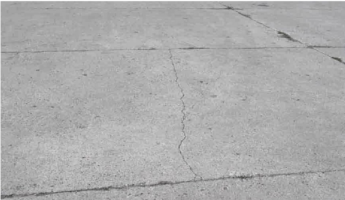
Rys. 5.2.2.4. Widok pęknięć poprzecznych
