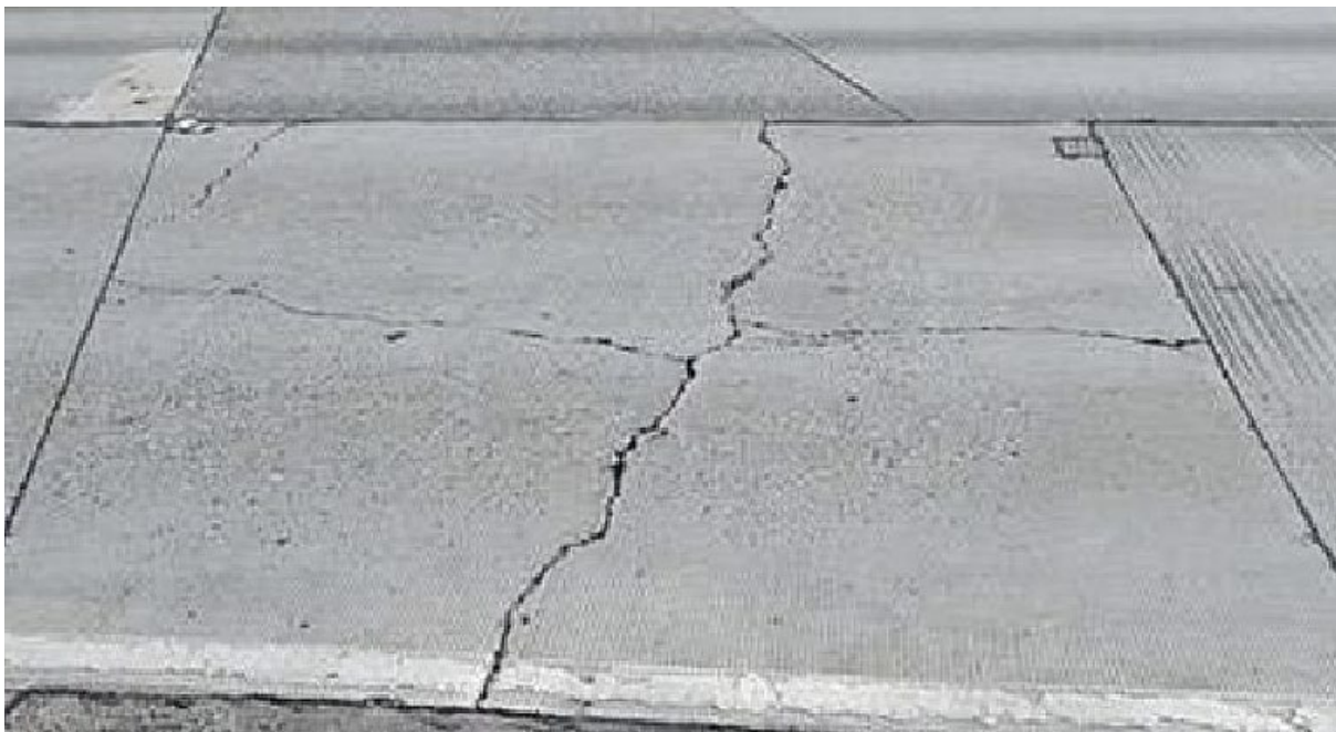
Rys. 5.2.2.9. Widok pęknięć blokowych
