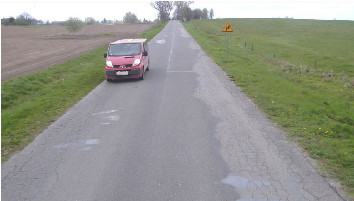
Rys. 5.1.2.3. Stan zły: spękania siatkowe i skupiska spękań zajmujące ponad 50% powierzchni [6]
