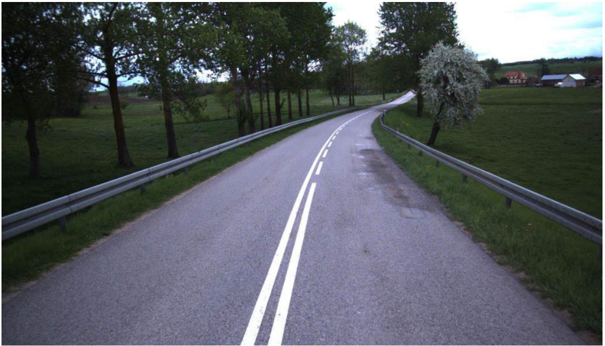
Rys. 5.1.3.5. Stan niezadowalający: łaty zajmujące do 20% powierzchni [6]
