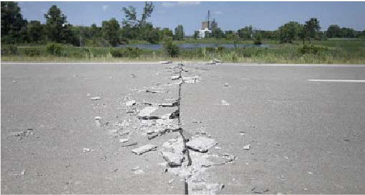
Rys. 5.2.4.2. Widok uszkodzenia szczeliny płyty
