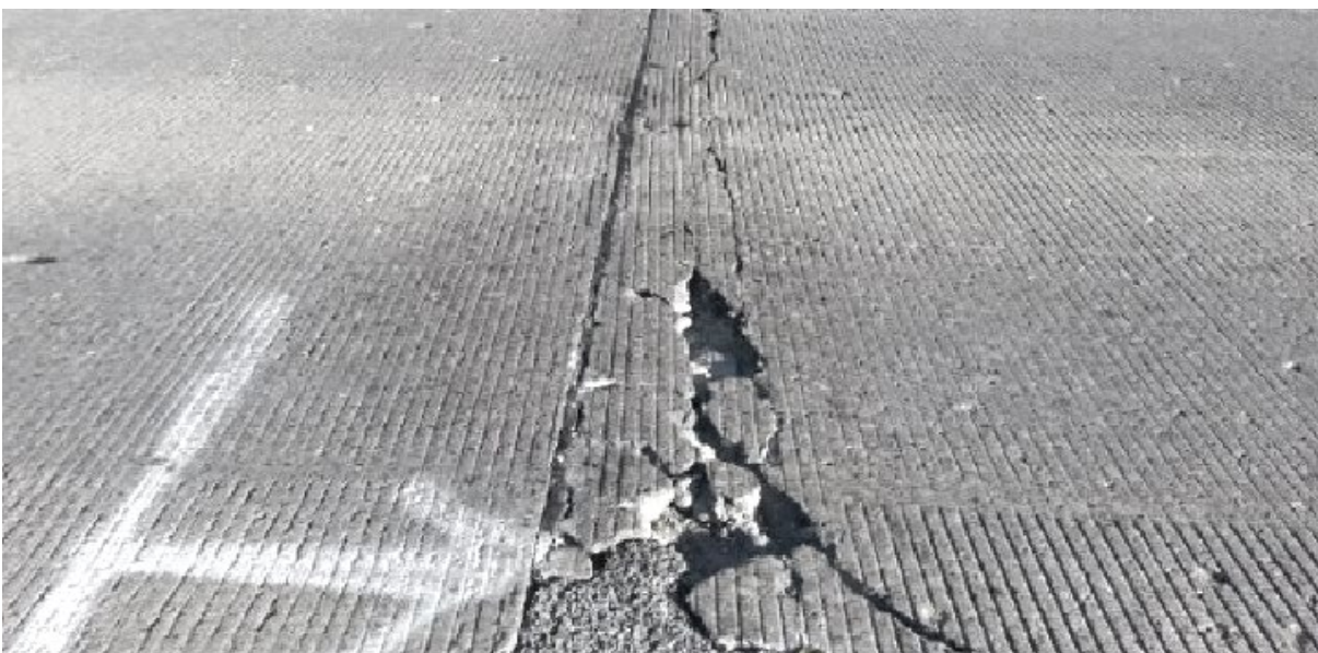
Rys. 5.2.5.1. Widok uszkodzeń z powodu nieprawidłowej pracy dybli
