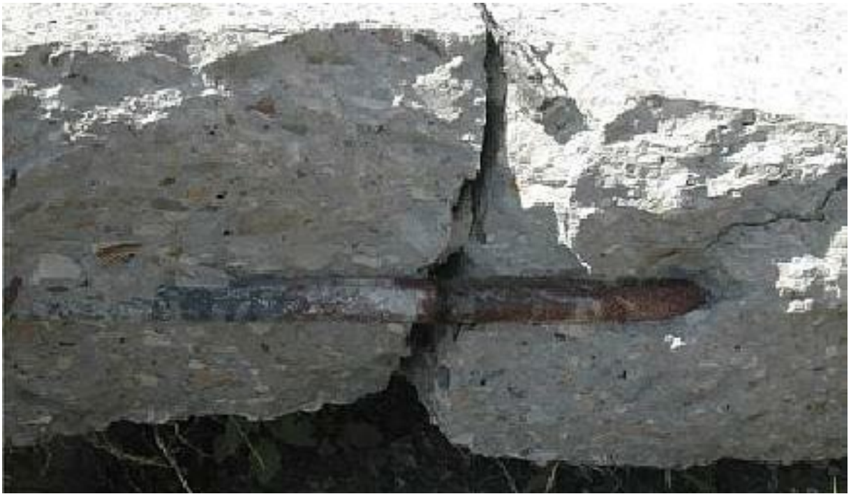
Rys. 5.2.5.2. Widok uszkodzeń z powodu nieprawidłowej pracy i korozji dybli
