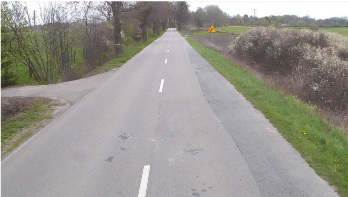
Rys. 5.1.3.4. Stan niezadowalający: łaty zajmujące do 20% powierzchni [6]
