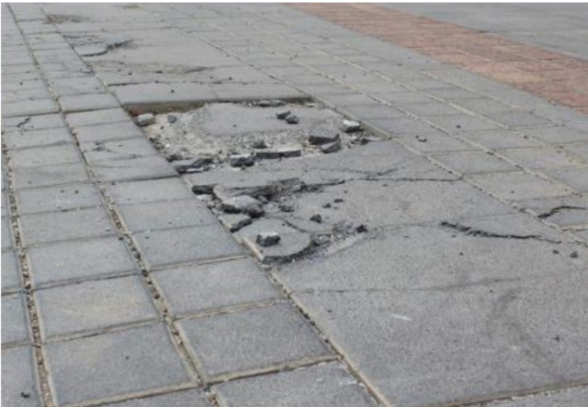
Rys. 6.10. Głębokie złuszczenia płyt chodnikowych z betonu cementowego
