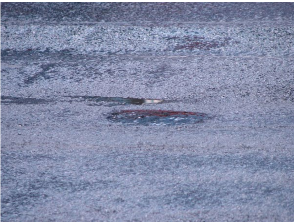
Rys. 5.1.3.8. Wypływ (plamy) lepiszcza
