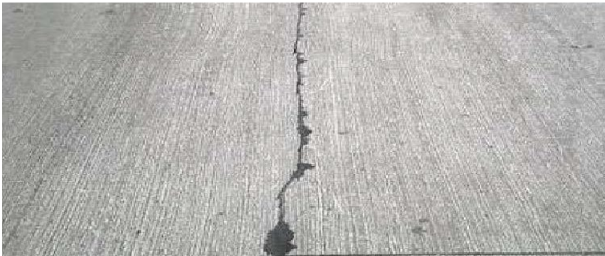
Rys. 5.2.2.1. Widok pęknięcia podłużnego na długości płyty
