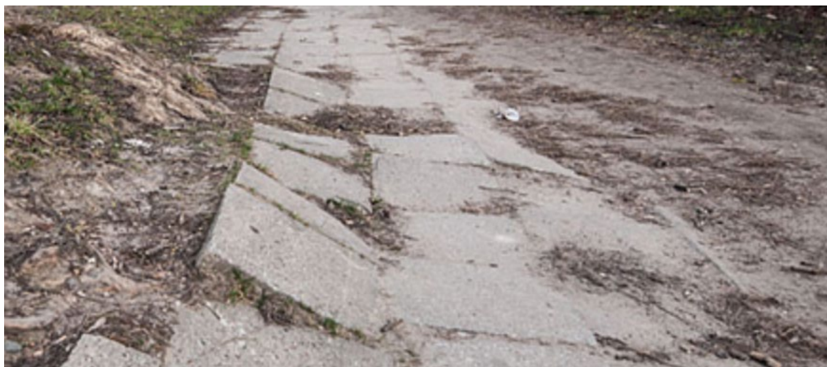
Rys. 6.1. Sfalowania płyt chodnikowych
