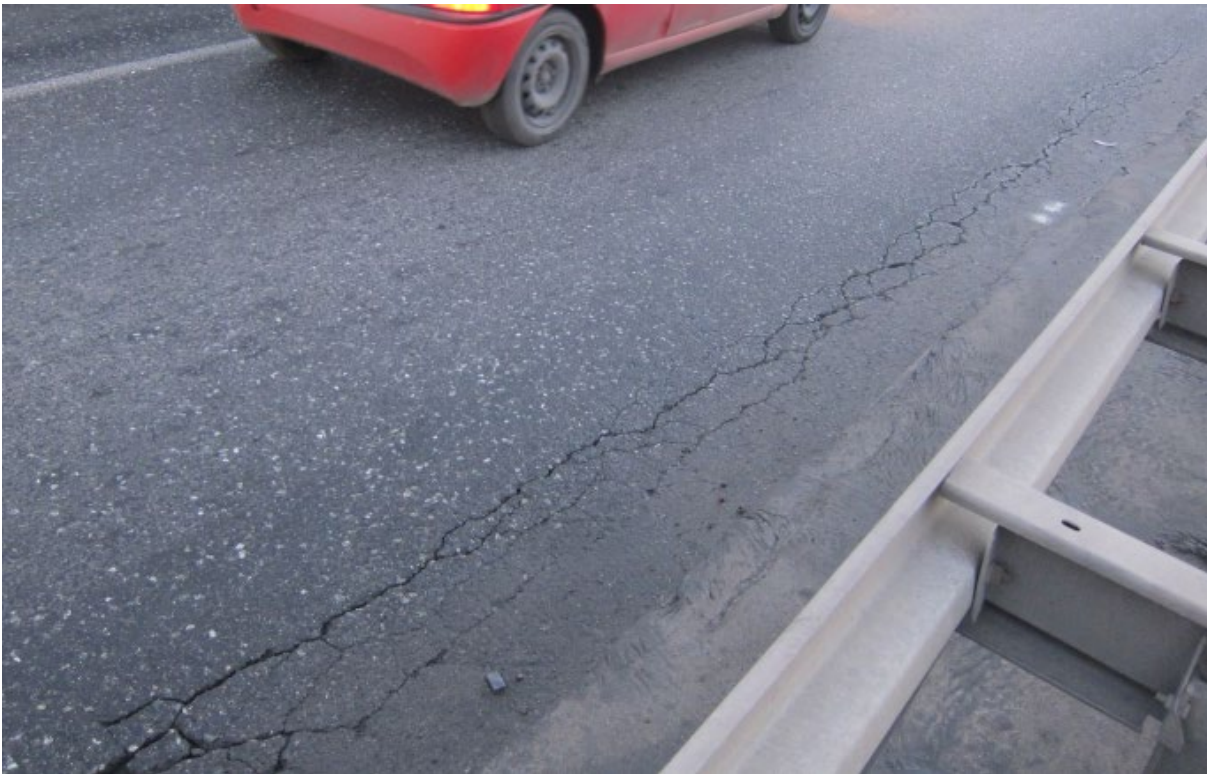
Rys. 5.1.2.7. Spękania zmęczeniowe podłużne (w śladzie nierówności poprzecznej)
