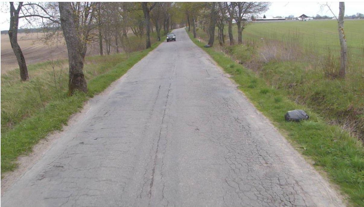
Rys. 5.1.2.4. Stan zły: spękania siatkowe zajmujące ponad 50% powierzchni [6]
