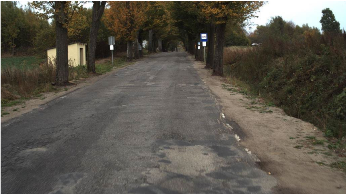
Rys. 5.1.1.5. Stan zły: liczne uszkodzenia zajmujące powyżej 50% powierzchni - nawierzchnia mocno skoleinowana [6]
