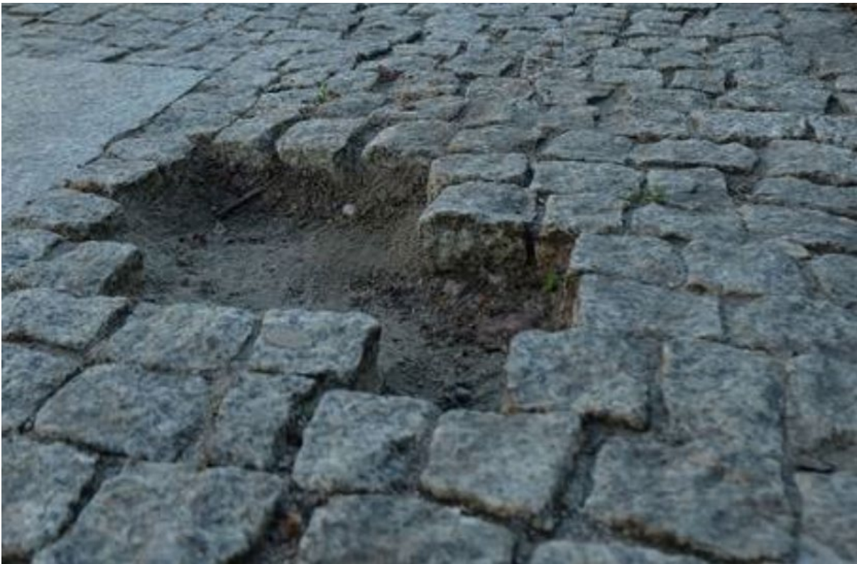
Rys. 6.9. Braki elementów chodnika z kostki kamiennej
