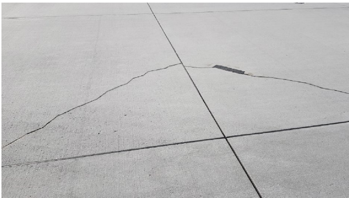
Rys. 5.2.2.6. Widok pęknięcia naroża
