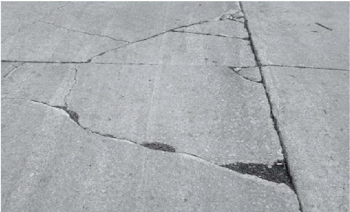
Rys. 5.2.2.10. Widok pęknięć blokowych w obszarze naroża
