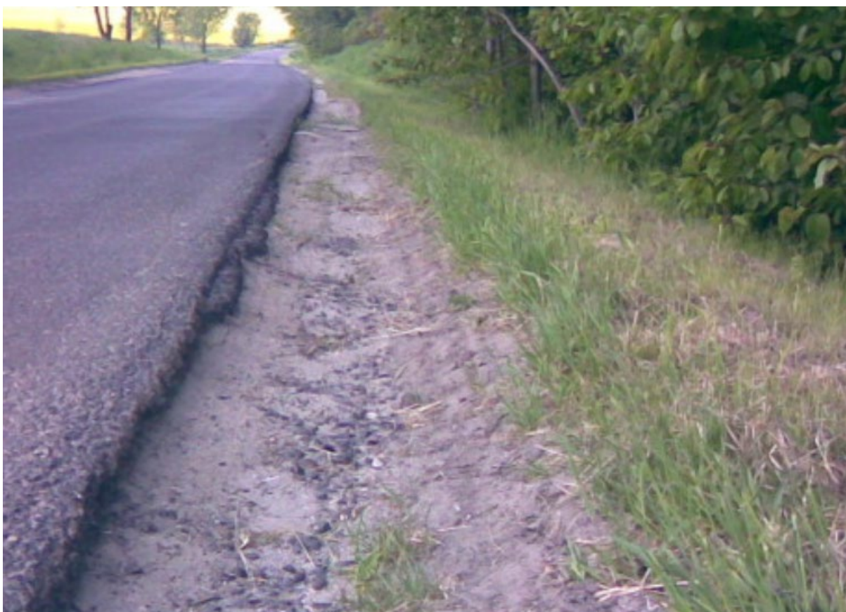
Rys. 7.1.1. Pobocze „skoleinowane” pierwszego rodzaju (zaniżone), powstałe wskutek ruchu pojazdów
