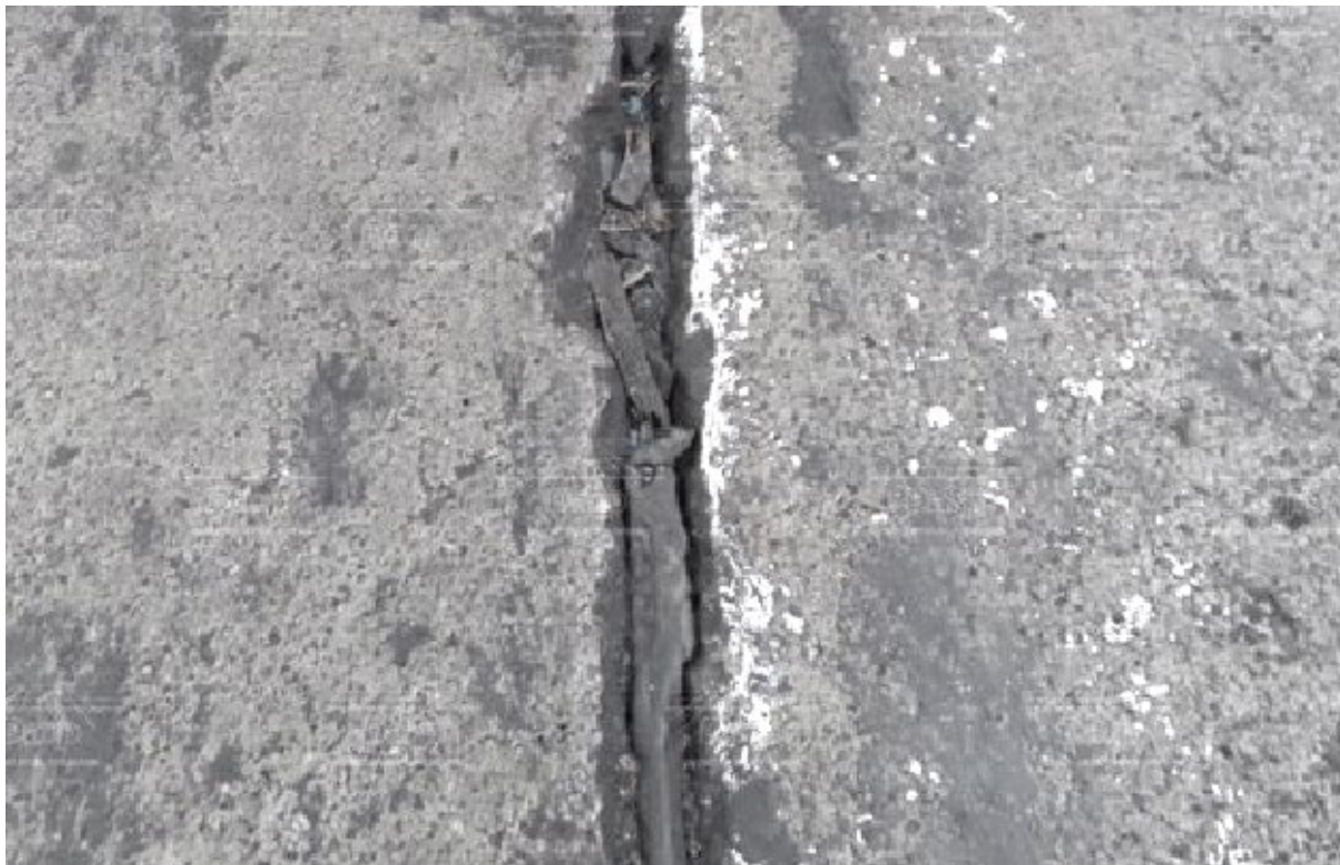
Rys. 5.2.4.4. Widok uszkodzenia wypełnień w szczelinie
