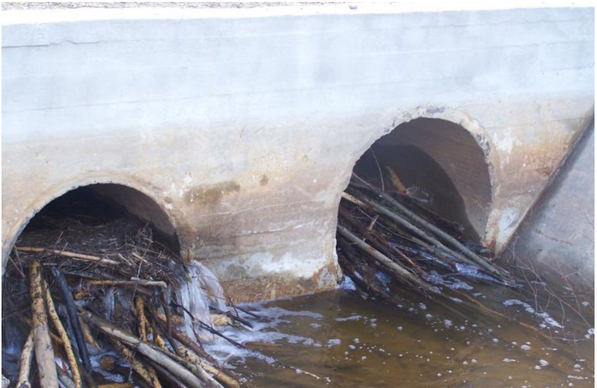
Rys. 7.2.3. Przepusty niedrożne powyżej 30% – stan zły
