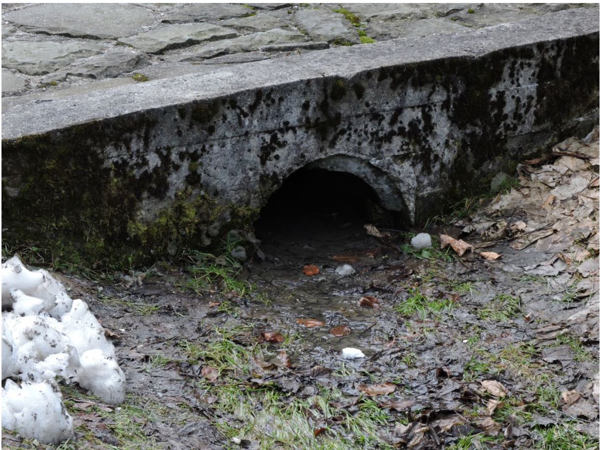
Rys. 7.2.4. Przepust niedrożny powyżej 50% – stan zły
