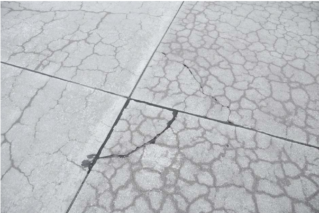
Rys. 5.2.3.5. Widok pęknięć alkalicznych
