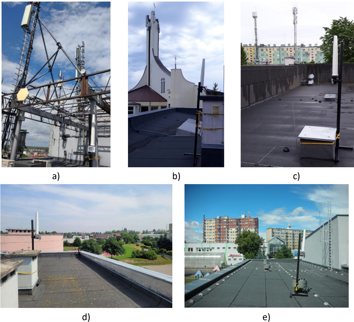
Rys. 2 Miejsca instalacji stacji monitorujących: (a) Suwałki, (b) Płock, (c) Gdynia, (d) Piotrków Trybunalski, (e) Piła
