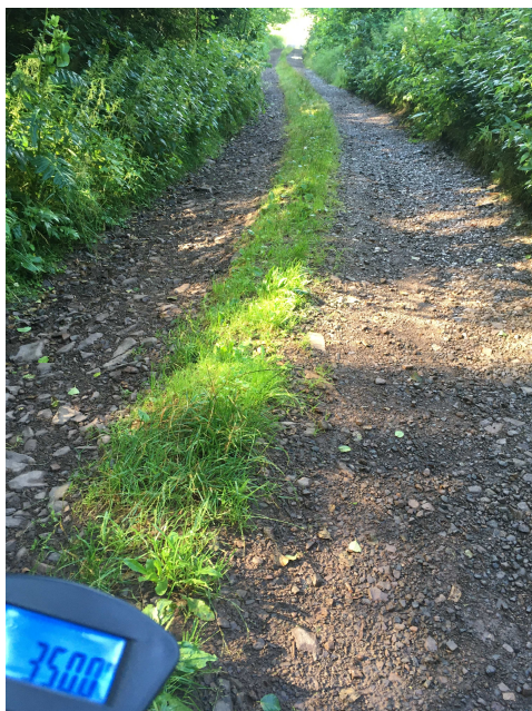
hm 3+50 – widoczne zniszczenie nawierzchni spowodowane wyfłukaniem kruszywa, zawyżone pobocza oraz zalegający w nawierzchni nanos materiału organicznego
