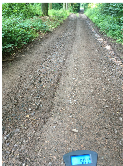
hm 0+50 – widoczne skoleinowanie nawierzchni oraz zawyżone pobocza uniemożliwiające odprowadzanie wody opadowej, zerodowana nawierzchnia
