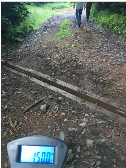
hm 1+50 – widoczne zniszczenie nawierzchni oraz istniejący wodospust drewniany przeznaczony do ponownego zabudowania w nowej nawierzchni
