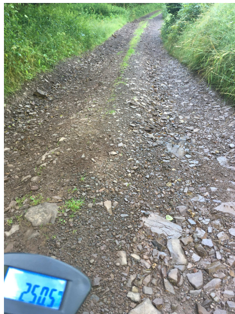
hm 2+50 – widoczne zniszczenie nawierzchni oraz skoleinowanie wywołane przez transport oraz wody opadowej, zawyżone pobocza jezdni uniemożliwiają odprowadzenie wody powodując erozję
