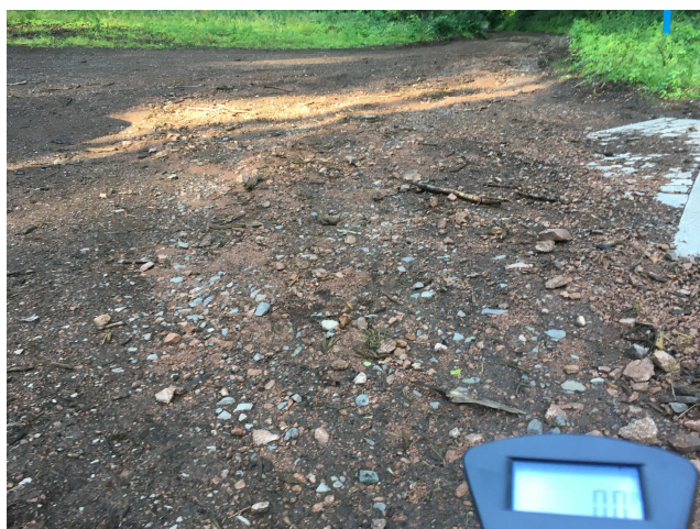
hm 0+00 – początek opracowania, widoczna zniszczona, zerodowana nawierzchnia,
