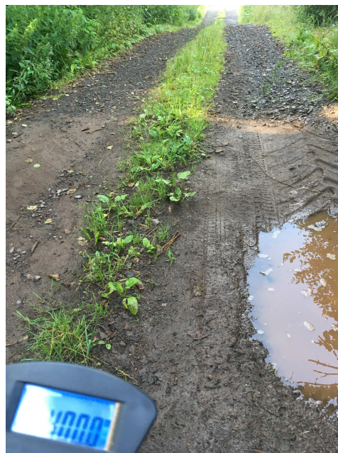
hm 3+87/4+00 koniec opracowania – widoczne skoleinowanie nawierzchni oraz zawyżone pobocza uniemożliwiające odprowadzanie wody opadowej, zalegający nanos gruntu organicznego w osi jezdni powodujący jej stałe zawilgocenie
