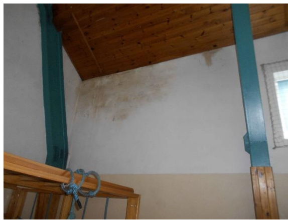
Rys. 21 Niewłaściwy stan sanitarno-higieniczny ściany
