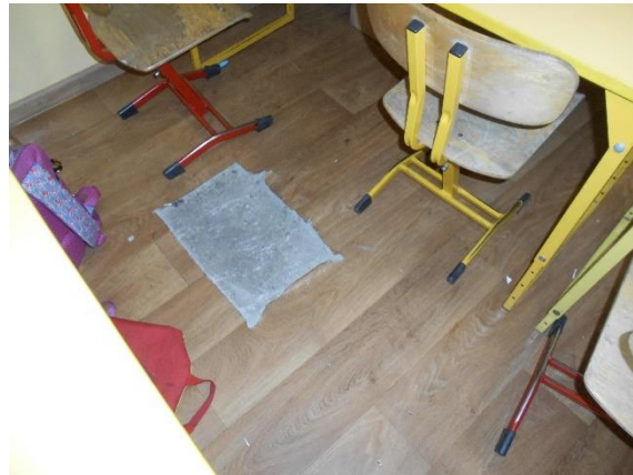
Rys. 23 Niewłaściwy stan sanitarno-higieniczny parkietu w sali zajęć.
