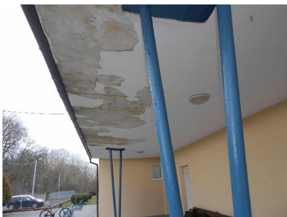
Rys. 20 Niewłaściwy stan techniczny sufitu zadaszenia wejścia do budynku szkoły.
