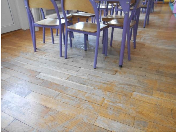
Rys. 22 Niewłaściwy stan techniczny nawierzchni wykładziny w sali zajęć.
