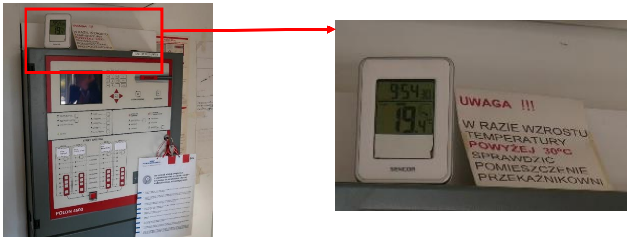
Zdjęcie 12 - Centrala w pomieszczeniu dyżurnego ruchu
