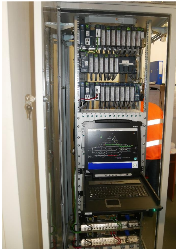
Zdjęcie 8 – Rozmieszczenie urządzeń w szafie komputerowej MOR-1
