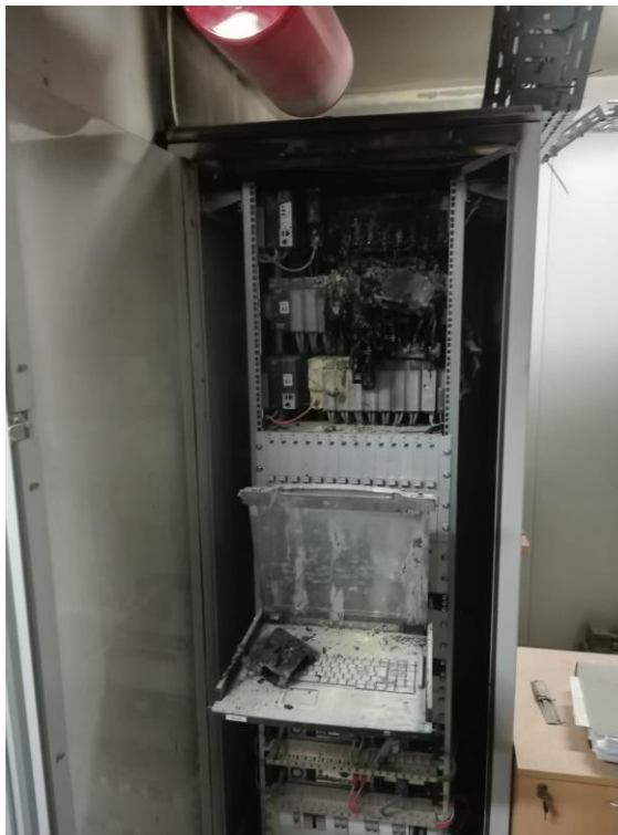
Zdjęcie 7 – Otwarta szafa komputerowa (fot. komisja kolejowa)
