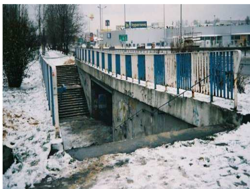
Rys. 3.21. Korozja balustrady wpływająca na estetykę i trwałość
