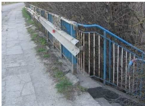
Rys. 5.1. Zanieczyszczenia i wegetacja roślin na chodniku nad konstrukcją oporową
