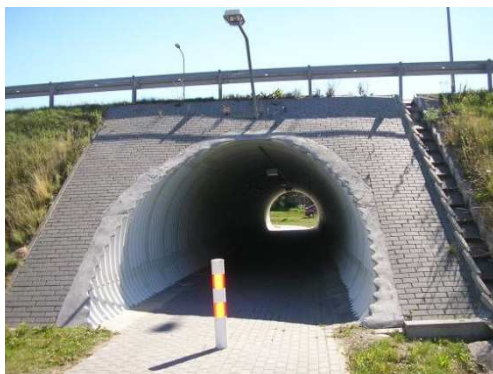
Rys. 3.46. Przejście podziemne o konstrukcji gruntowo-powłokowej o przekroju zamkniętym. Stan fundamentu niewzbudzający zastrzeżeń, brak osiadań oraz deformacji konstrukcji i innych ewentualnych uszkodzeń spowodowanych złym stanem fundamentu
