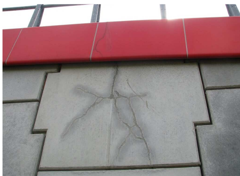
Rys. 5.32. Rysy o rozwarości 1 mm na prefabrykacie konstrukcji oporowej
