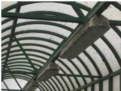
Rys. 3.72. Zanieczyszczenia elementów oświetlenia
