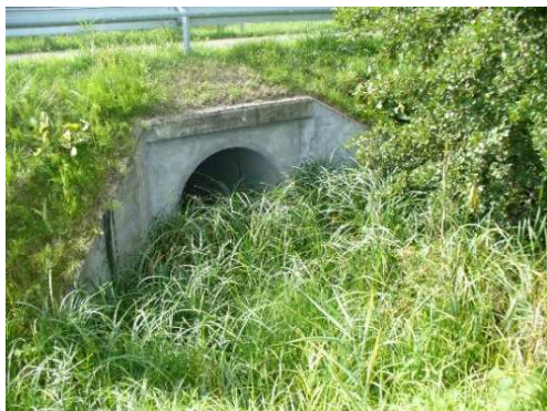
Rys. 4.83. Wegetacja roślin zmniejszająca przekrój koryta ciekutrudnia przepływ wody
