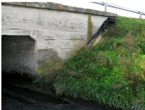
Rys. 3.3. Przemieszczenia i osiadanie gruntu skarpy powodujące odstąpienie ściany czołowej
