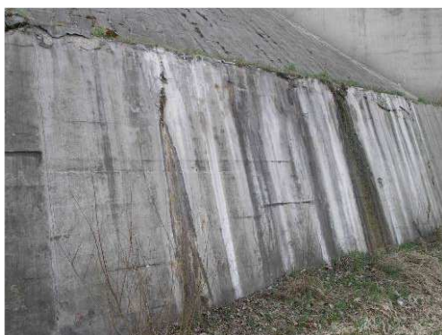
Rys. 5.20. Przecieki wody, osady na 50% powierzchni, miejscowe zniszczenie struktury materiału
