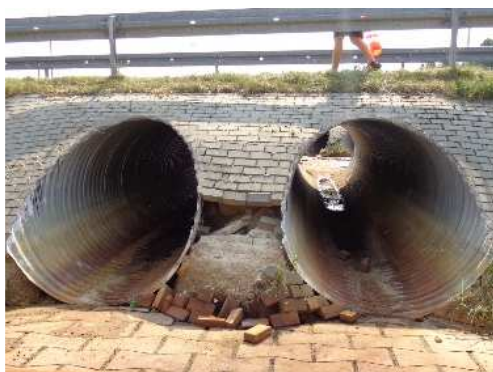
Rys. 4.4. Uszkodzenie umocnionej skarpy w strefie wylotu przepustu zagrażające trwałości. Ubytki gruntu, ubytki i przemieszczenia kostki betonowej, wegetacja w spoinach obrukowania
