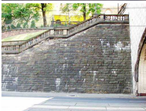
Rys. 3.52. Przecieki, wykwity, korozja i ubytki elementów kamiennych
