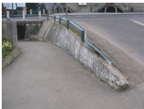
Rys. 5.10. Zdeformowana bariera, uszkodzone połączenie bariery ze słupkami
