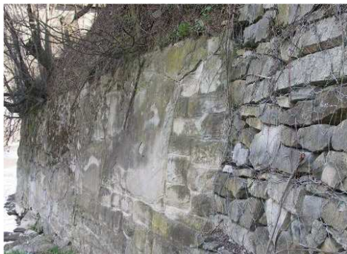
Rys. 5.2. Drzewa rosnące bezpośrednio nad konstrukcją oporową zagrażające jej trwałości
