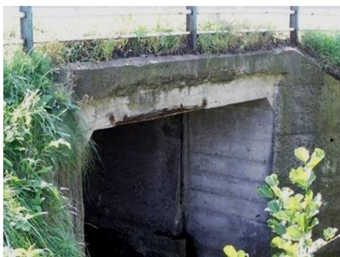
Rys. 4.66. Miejscowe ubytki betonu i korozja zbrojenia
