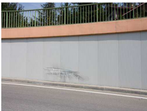
Rys. 5.40. Konstrukcja oporowa wykonana z prefabrykatów stalowych (ścianka szczelna) z betonowym zwieńczeniem i obudową z blach. Widoczne miejscowe uszkodzenie (otarcie) obudowy
