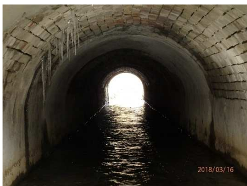
Rys. 4.41. Przecieki przez sklepienie ceglane, ubytki wypełnienia spoin, osady i wykwyty na powierzchni sklepienia
