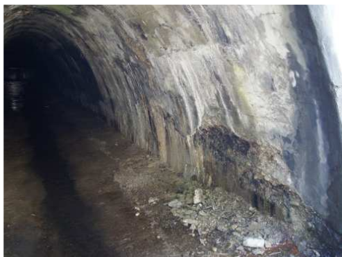
Rys. 4.40. Zaawansowana degradacja betonu sklepienia, korozja i ubytki betonu, osady i wykwyty, przecieki
