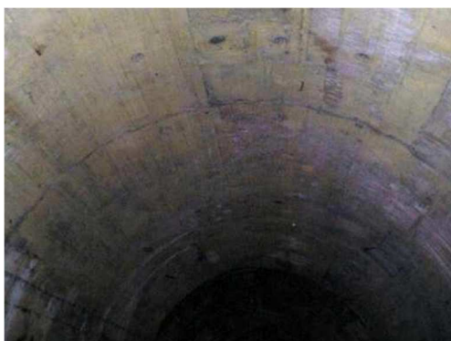
Rys. 3.41. Wykwity na sklepieniu betonowym świadczące o korozji ługującej
