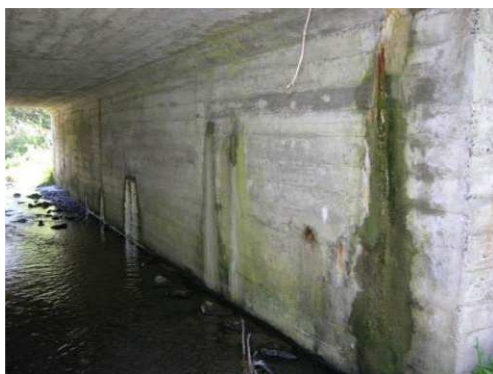
Rys. 4.42. Widoczne przecieki, korozja betonu (łuszczenie), wegetacja roślin (mchu) na ścianie przepustu ramownicowego
