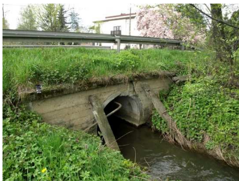
Rys. 4.72. Pęknięcie i przemieszczenie głowicy, ścianka czołowa tymczasowo podparta betonowymi deskami
