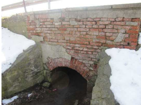
Rys. 4.73. Ubytki, korozja i pęknięcia cegieł, ubytki wypełnienia spoin, ubytki betonowej wyprawy stanowiącej zabezpieczenie antykorozyjne ścian bocznych sklepienia, rysy i ubytki betonu w skrzydłach
