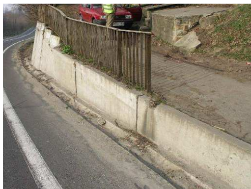
Rys. 5.9. Całkowite zniszczenie powłoki anty-korozyjnej, początki korozji balustrady
