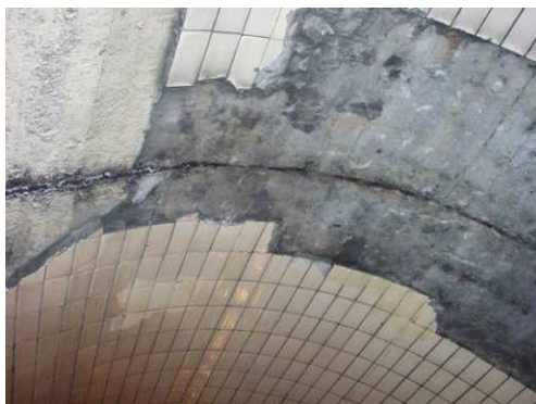
Rys. 3.58. Odpadanie elementów okładziny ze stropu tunelu (zagrożenie dla bezpieczeństwa użytkowników)
