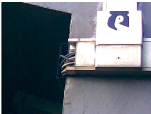
Rys. 3.97. Uszkodzenia osłon kabli energetycznych
