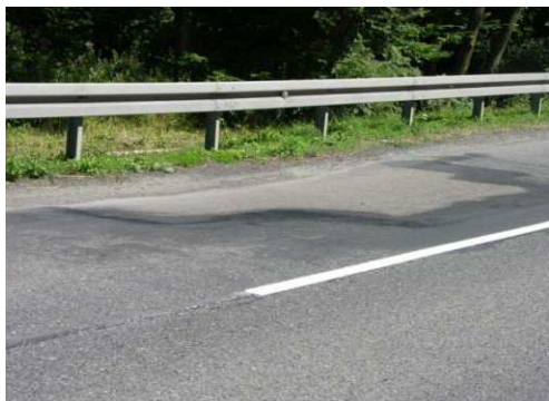
Rys. 4.11. Obniżenie nawierzchni jezdni nad przepustem o ok. 50 mm
