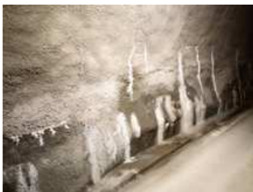
Rys. 3.70. Rozległe przecieki świadczące o nieskutecznej izolacji
