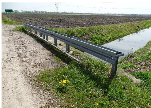
Rys. 4.21. Brak kilku słupków oraz odcinków początkowych i końcowych, ostre zakończenia prowadnicy zagrażające bezpieczeństwu ruchu
