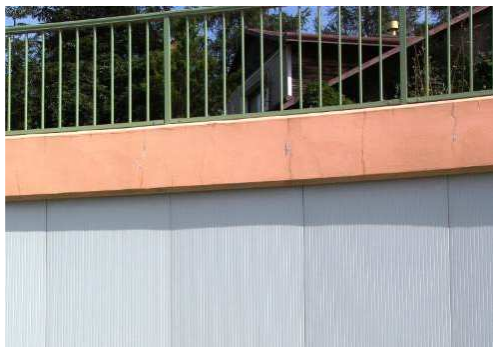
Rys. 5.52. Rysy skurczowe obejmujące ok. 20% powierzchni gzymsu
