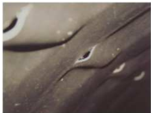
Rys. 4.55. Deformacje, pęknięcia elementu rurowego
