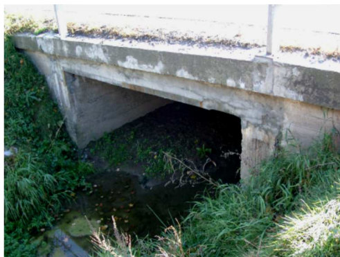
Rys. 4.48. Zanieczyszczona płyta denna – utrudniony przepływ wody
