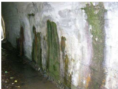
Rys. 4.33. Przecieki i zacieki wody przez ścianę przepustu świadczące o całkowitym uszkodzeniu izolacji
