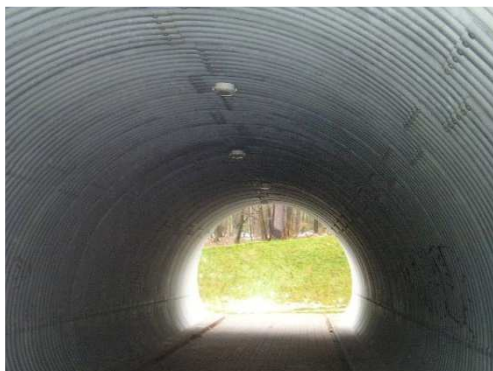
Rys. 3.74. Urządzenia oświetlenia kompletne i sprawne, bez uszkodzeń
