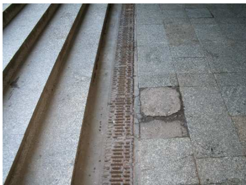
Rys. 3.64. Zanieczyszczenie i korozja powierzchniowa elementów urządzenia odwadniającego w przejściu podziemnym
