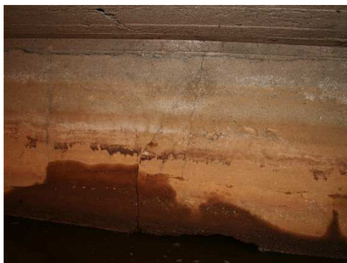
Rys. 4.43. Widoczne pionowe pęknięcia o rozwarości ponad 1.5 mm, powstałe na skutek przeciążenia. Ubytki betonu, osady i zacieki
