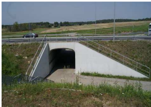
Rys. 3.30. Niewielkie zanieczyszczenie oraz uszkodzenie powłok ochronnych na ścianach czołowych
