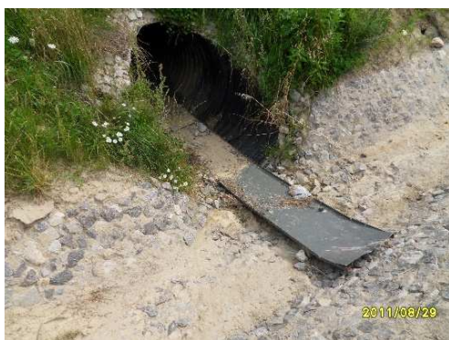
Rys. 4.95. Przepust z blachy falistej zintegrowany z przejściem dla małych zwierząt z półką z blachy stalowej – deformacja blachy przed wlotem do przepustu oraz brak zasypki na blasze mogące utrudniać migrację
