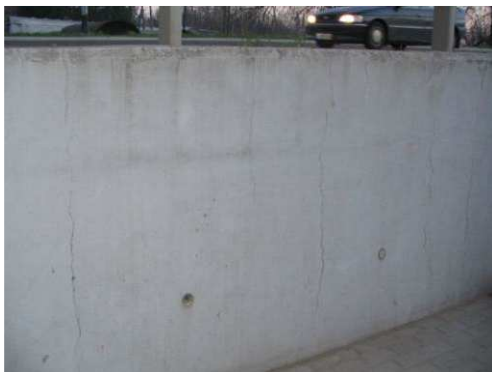
Rys. 5.14. Rysy o rozwarości ok. 0.5 mm w rozstawie ok. 2 m, brak wypełnienia otworu po ściąganiu deskowania
