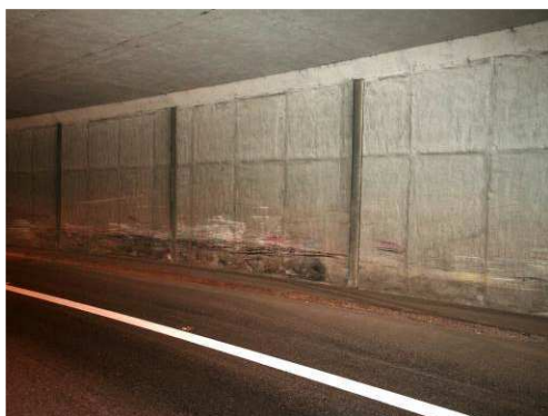
Rys. 3.33. Zanieczyszczenia, otarcia i niewielkie ubytki betonu ściany tunelu niewpływające na trwałość
