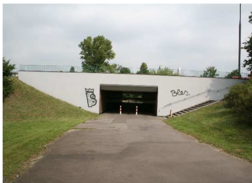
Rys. 3.31. Zanieczyszczenia ściany czołowej przejścia podziemnego na powierzchni ponad 5%,
