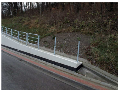
Rys. 5.11. Brak fragmentu balustrady
