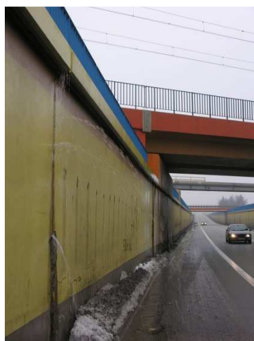
Rys. 5.43. Wadliwe odwodnienie powierzchniowe. Brak drożności elementów systemu odwodnienia wewnętrznego
