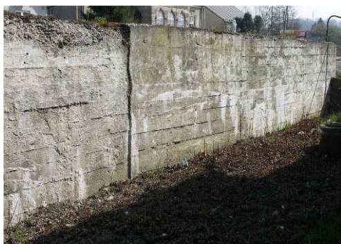
Rys. 5.48. Korozja ługująca świadcząca o braku skutecznej izolacji
