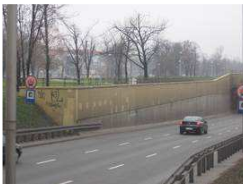
Rys. 3.48. Nieliczne zanieczyszczenia (graffiti) występujące na ścianie oporowej
