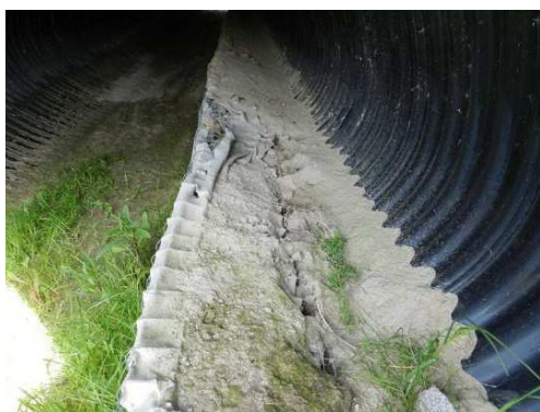
Rys. 4.94. Przepust z blachy falistej zintegrowany z przejściem dla małych zwierząt z półką z koszy kamiennych – uszkodzenia geowłókniny powodujące ubytki zasypki piaskowej, mogące utrudniać migrację
