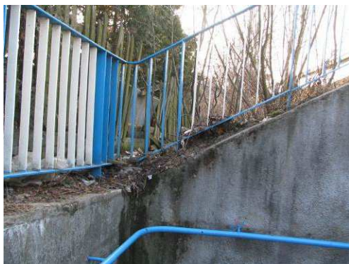
Rys. 3.50. Zanieczyszczenia występujące na ścianie oporowej, niewielkie (nieprzekraczające 5% powierzchni) przecieki wody oraz wykwity świadczące o korozji ługującej
