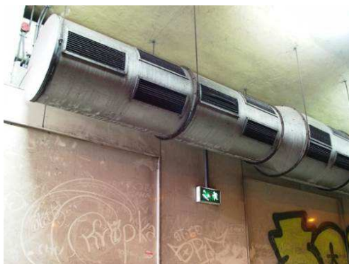
Rys. 3.77. Sprawnie działające urządzenia wentylacyjne
