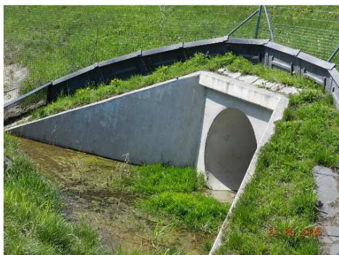
Rys. 4.76. Głowica przepustu rurowego – nie-wielkie zanieczyszczenie ścianki czołowej, skrzydeł, wegetacja na betonie płyty dennej
