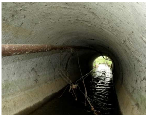
Rys. 4.87. Nieprawidłowe (osłabione) zamocowanie urządzenia obcego, skorodowana rura osłonowa urządzenia
