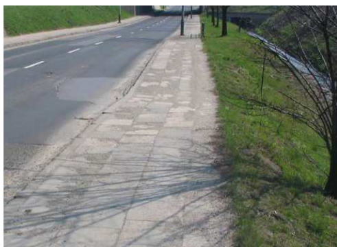
Rys. 5.3. Zapadnięcie jezdni i poziome przemieszczenie chodnika nad konstrukcją oporową z koszy siatkowych
