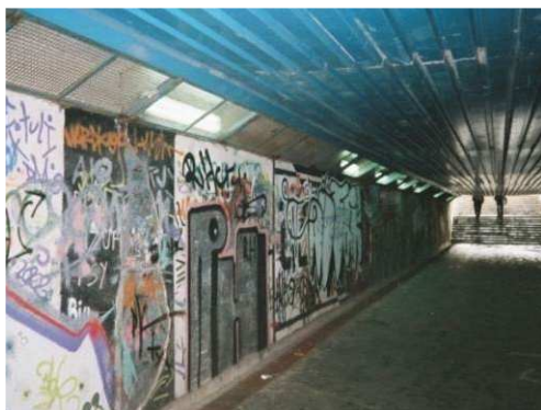
Rys. 3.73. Część elementów oświetlenia uszkodzona i niesprawna
