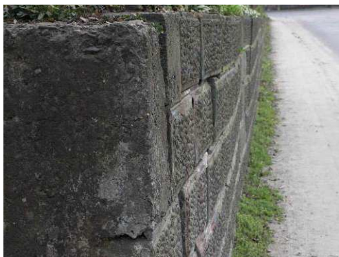
Rys. 5.25. Przemieszczenie elementów konstrukcji niewpływające na trwałość ani stateczność. Wskazane wykonanie przeglądu szczegółowego w celu udokumentowania i zinwentaryzowania przemieszczeń
