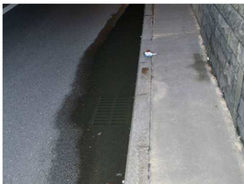
Rys. 3.62. Zanieczyszczenie powodujące całkowitą niedrożność pojedynczego urządzenia odwadniającego
