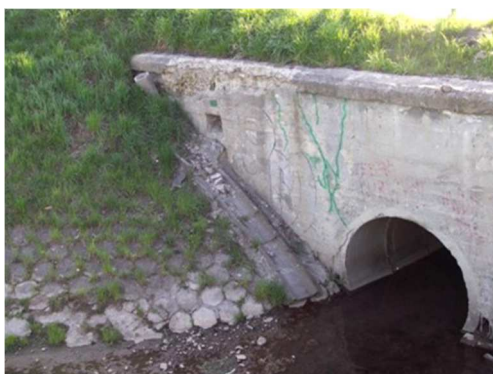
Rys. 4.69. Ubytki betonu na głowicy przepustu
