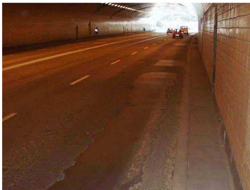
Rys. 3.7. Niewielkie zanieczyszczenia, deformacje do 10 mm
