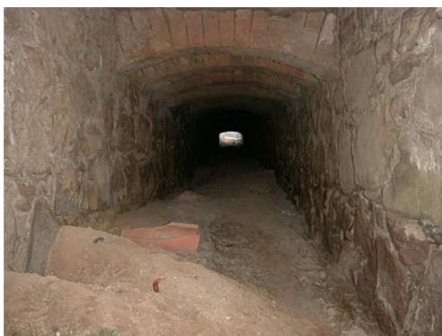
Rys. 4.47. Ściany przepustu kamiennego bez uszkodzeń, niewielka miejscowa korozja (fusz-czenie) materiału konstrukcyjnego
