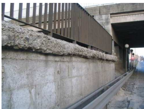
Rys. 5.54. Gzyms zniszczony, ubytki betonu, zacieki, osady
