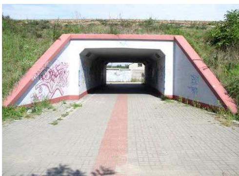
Rys. 3.90. Teren nad przejściem podziemnym wymagający uporządkowania i poprawy estetyki
