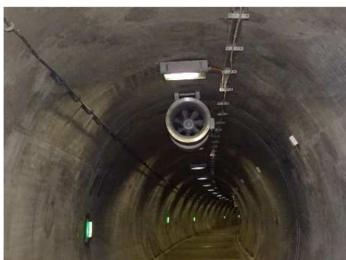
Rys. 3.79. Sprawnie działające urządzenia wentylacyjne w tunelu ewakuacyjnym
