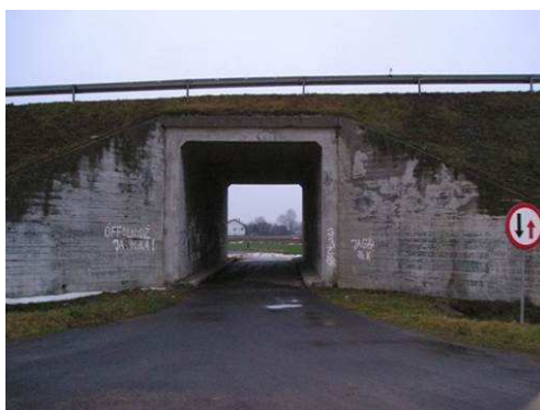
Rys. 3.51. Zanieczyszczenia (graffiti) występujące na konstrukcji oporowej, przecieki wody oraz wykwity świadczące o korozji ługującej
