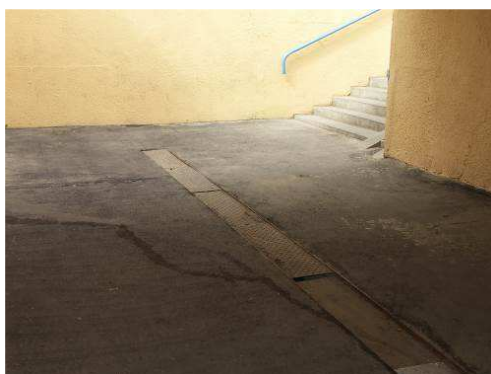
Rys. 3.13. Niewielkie zanieczyszczenia i nierówności nawierzchni w przejściu podziemnym
