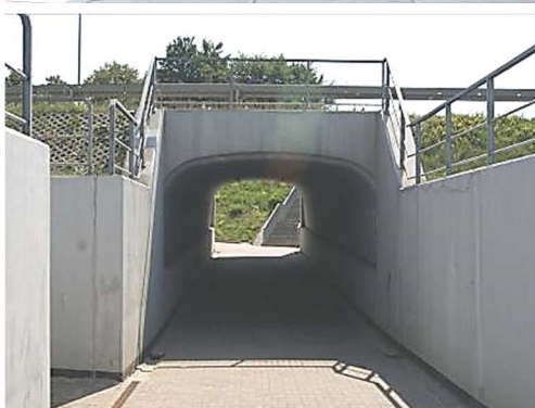
Rys. 3.53. Konstrukcje oporowe niepołączone monolitycznie z głowicami obiektu, brak uszkodzeń
