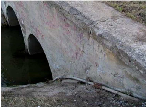
Rys. 4.84. Uszkodzenia osłony i zamocowania kabla telekomunikacyjnego
