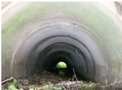
Rys. 4.51. Zanieczyszczenia przewodu od 20 do 30% powierzchni przekroju
