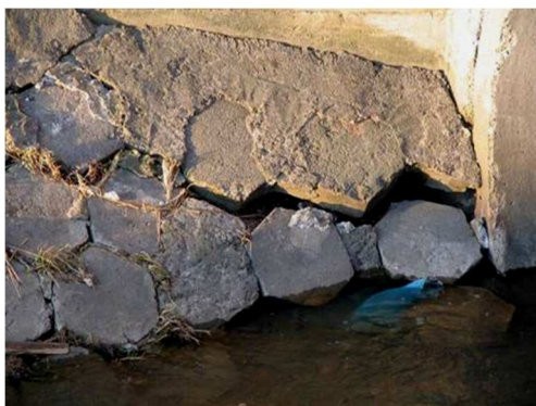
Rys. 4.79. Podmycie umocnienia skarpy ciek i przemieszczenie elementów wzmacniających skarpe
