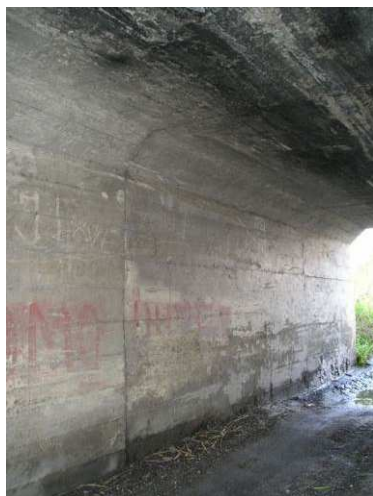
Rys. 3.66. Przecieki na stropie tunelu
