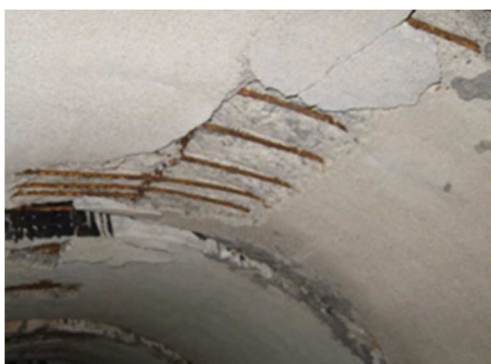
Rys. 4.53. Ubytki i rysy betonu, korozja zbrojenia, przemieszczenie sąsiednich elementów przepustu rurowego
