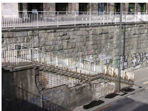
Rys. 5.57. Korozja balustrad, korozja i ubytki okładziny schodów
