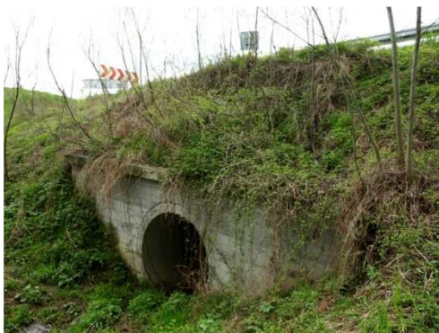
Rys. 4.6. Wegetacja roślinności wymagająca prac utrzymaniowych, zagrażająca trwałości nasypu i skarpy
