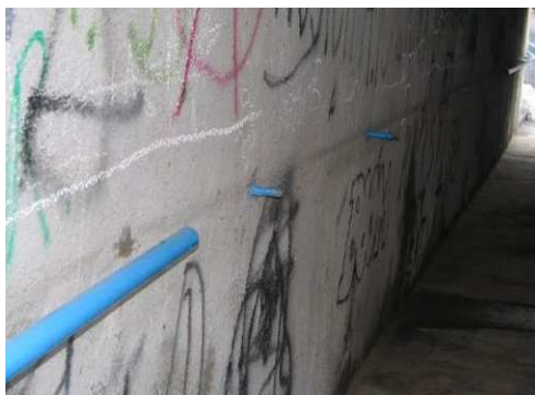
Rys. 3.22. Brak poręczy balustrady
