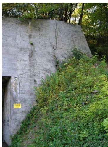
Rys. 3.2. Wegetacja roślinna na skarpie pogarszająca estetykę obiektu
