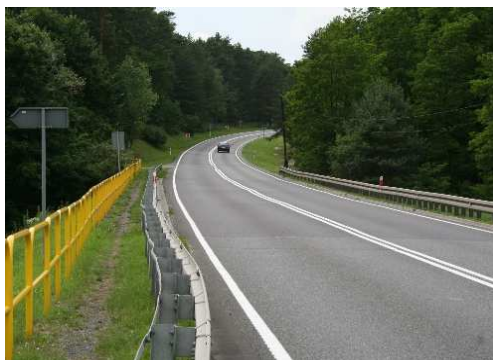
Rys. 4.12. Deformacje nawierzchni jezdni nad przepustem i dojazdami (do 20 mm), sfalowania widoczne na środkowej linii podwójnej ciągłej P4
