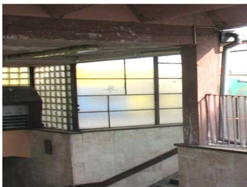
Rys. 3.45. Niewielkie (nieprzekraczające 5% powierzchni) zacieki i wykwyty na podporze świadczące o rozwijającej się korozji ługującej
