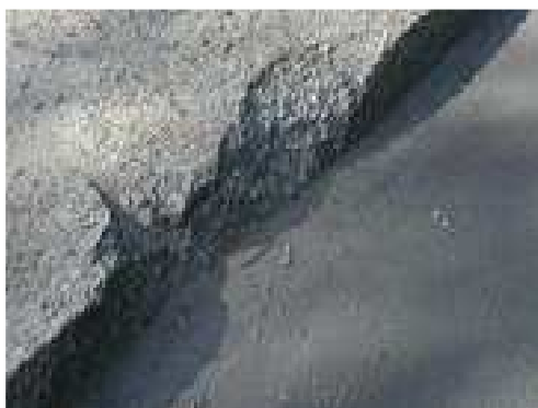
Rys. 3.14. Ubytki betonu krawężnika
