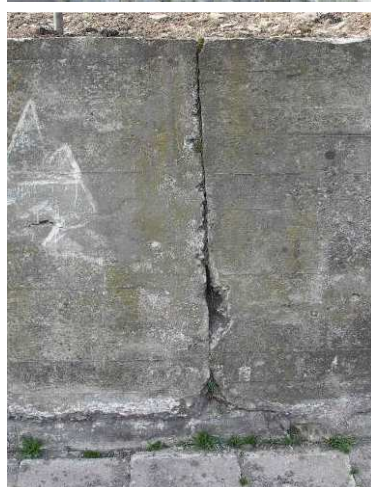
Rys. 5.50. Nieliczne ubytki betonu w otoczeniu szczeliny dylatacyjnej pogarszające estetykę konstrukcji. Brak wycieków wody
