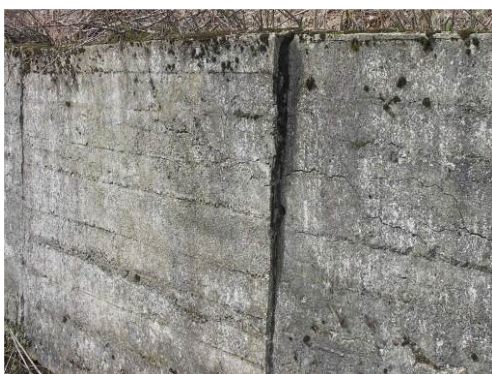
Rys. 5.16. Przemieszczenie konstrukcji oporowej. Z dokumentacji przeglądów wynika, że przemieszczenie wystąpiło wiele lat temu i się nie zmienia. Można więc uznać, że nie ma zagrożenia dla stateczności konstrukcji. Występują rysy poziome, złuszczenia, osady i miejscowa wegetacja roślin
