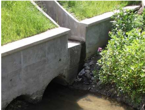
Rys. 4.26. Odwodnienie sprawnie działające, bez uszkodzeń, niewielkie zanieczyszczenia. Wskazane jest wykonanie krótkiego ścieku na skarpie
