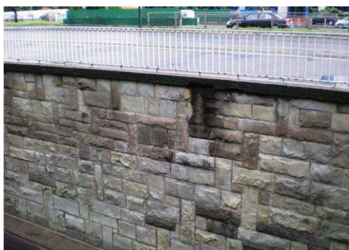
Rys. 5.47. Miejscowe przecieki wody świadczące o nieskutecznej izolacji
