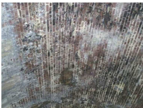
Rys. 3.40. Przecieki, ubytki oraz wykwyty i osady na sklepieniu z cegły świadczące o korozji materiału
