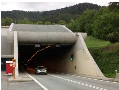
Rys. 3.34. Niewielkie uszkodzenia powłoki ochronnej na ścianach obudowy tunelu
