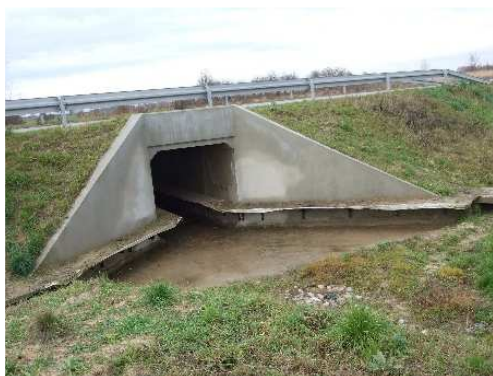
Rys. 4.92. Przepust skrzynkowy zintegrowany z przejściem dla małych zwierząt z półkami z blachy stalowej – niewielkie deformacje blachy, lokalne ubytki powłoki malarskiej oraz korozja powierzchniowa na blasze oraz elementach wsporczych
