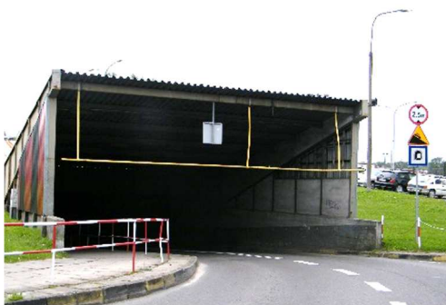
Rys. 3.25. Osłona (zadaszenie) i ogranicznik skrajni na wjeździe do tunelu ze zniszczonymi powłokami antykorozyjnymi. Korozja wżerowa i miejscowe deformacje
