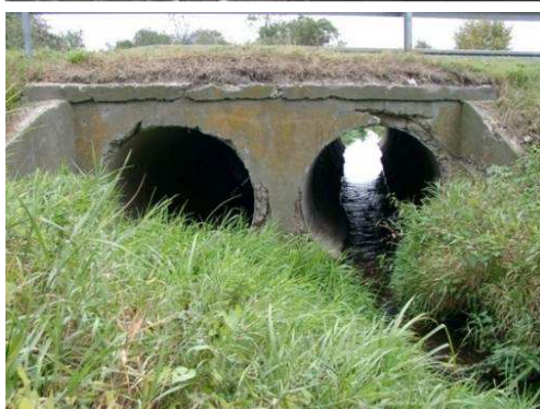
Rys. 4.70. Ubytki betonu i korozja zbrojenia głowicy
