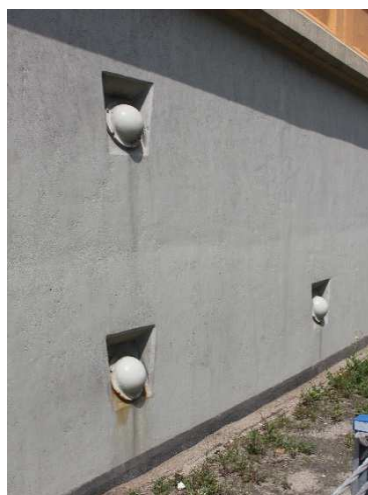
Rys. 5.61. Miejscowa, powierzchniowa korozja obudowy/osłon zakotwień
