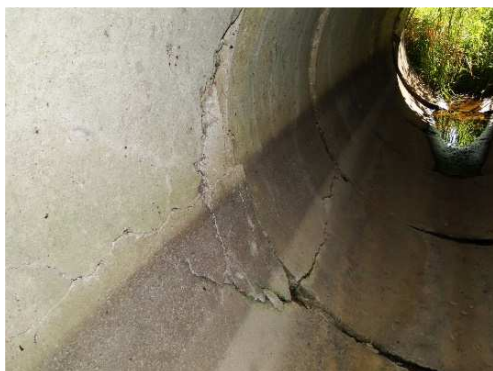
Rys. 4.58. Pęknięcia i rysy równoległe do osi przepustu o charakterze przeciążeniowym, ubytki betonu w strefach stykowych prefabrykowanych elementów rurowych
