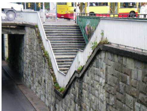
Rys. 5.53. Zanieczyszczenia i wegetacja roślin na gzymsie
