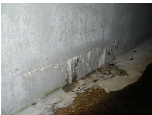
Rys. 4.45. Widoczne lokalne, poziome zarysowanie z białym wyługowaniem i zawilgoce niem świadczące o przecieku przez ścianę wysokiego przepustu sklepionego
