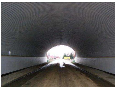
Rys. 3.11. Zanieczyszczenie nawierzchni, zastoiska wody na jezdni oraz w strefach ścieków przykrawężnikowych
