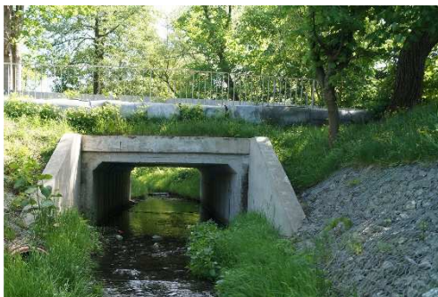
Rys. 4.8. Wegetacja roślinności (w tym drzew) zagrażająca trwałości nasypu i skarpy, wymagająca prac utrzymaniowych. Ubytki materiału skarpy
