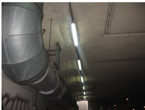
Rys. 3.78. Sprawnie działające urządzenia wentylacyjne, dobry stan przewodów wentylacyjnych i elementów mocujących do konstrukcji
