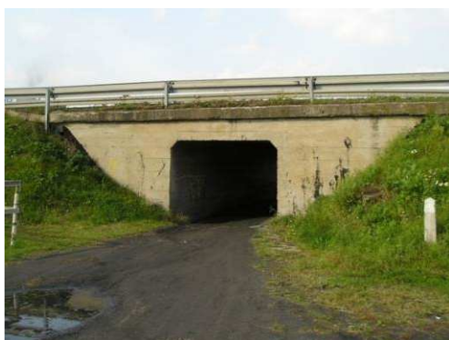
Rys. 3.4. Przemieszczenia i osiadanie gruntu skarpy powodujące odstąpienie ściany czołowej
