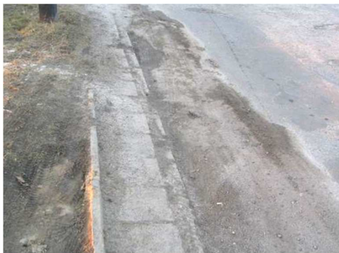
Rys. 4.10. Zanieczyszczenia jezdni nad przepustem utrudniające przepływ wody
