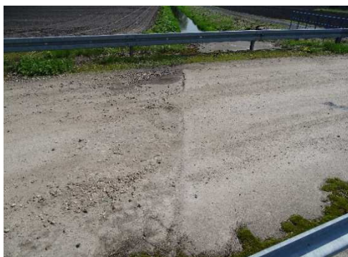
Rys. 4.13. Ubytki i przemieszczenia nawierzchni na dojeździe do przepustu, nierówności progowe, wegetacja na nawierzchni i poboczach gruntowych, zanieczyszczenie nawierzchni
