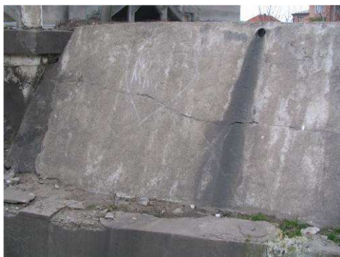
Rys. 5.17. Poziome pęknięcie korpusu powstałe w miejscu przerwy w betonowaniu konstrukcji, niespowodowane przemieszczeniem ściany, brak wycieków ze szczeliny
