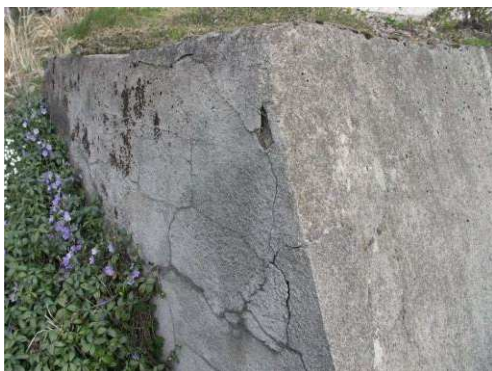
Rys. 5.15. Miejscowe zniszczenie struktury materiału
