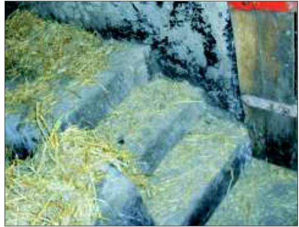
Zanieczyszczone schody w budynku inwentarskim fot. OR w Rawiczu
