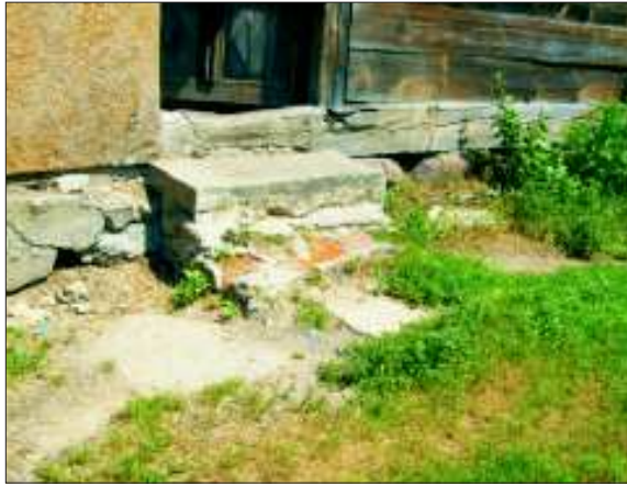
Zniszczone, nierówne schody fot. OR w Ostrołęce
