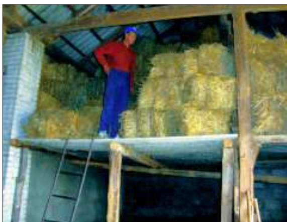
Brak barier na wysokości i listwy przypodłogowej fot. OR w Radomiu
