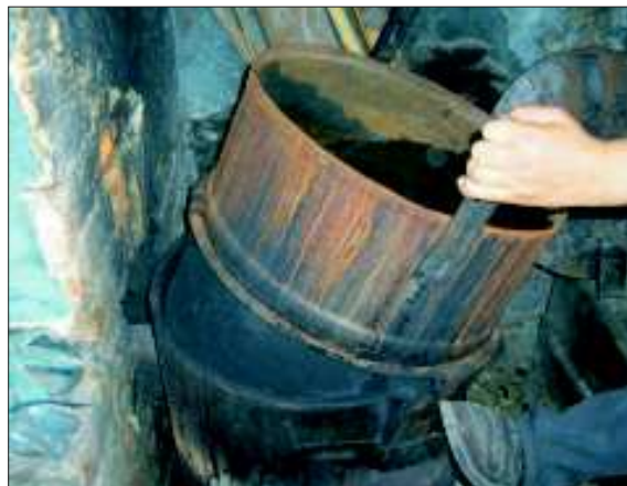
Brak pokrywy w parniku, nieumiejętne wykonywanie czynności fot. OR w Kielcach
