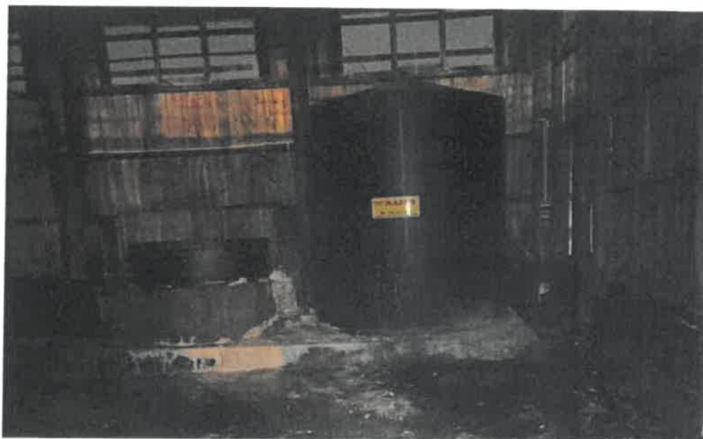
6. Wytwornica soli do demontażu.
