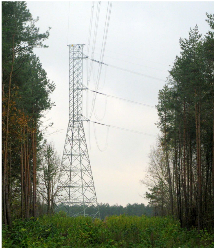
Fot. 8. Dzięki zastosowaniu słupów leśnych (tutaj jednotorowy słup leśny mocny), na których przewody są zawieszane w jednej płaszczyźnie, możliwe jest niemal dwukrotne ograniczenie pasa wycinki drzewostanu (do ok. 32m). Jednak słupy te muszą być przez to wyższe i linia przebiega zasadniczo nad drzewostanem tworząc pewne zagrożenie dla migrujących ptaków. Fot. M.M.
