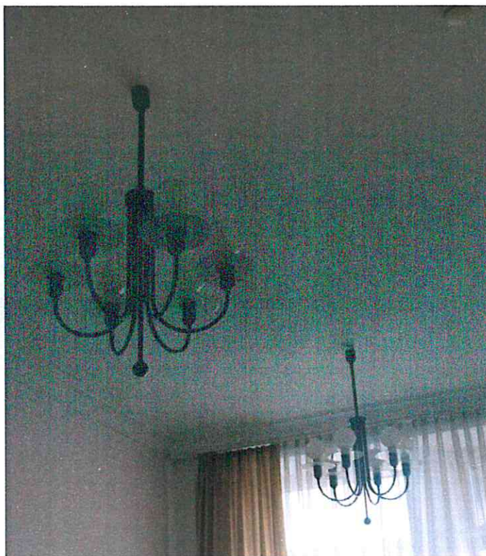
Fotografia 4 Pomieszczenie 118 – oprawy ozdobne – żyrandole ze świetlówkami kompaktowymi
