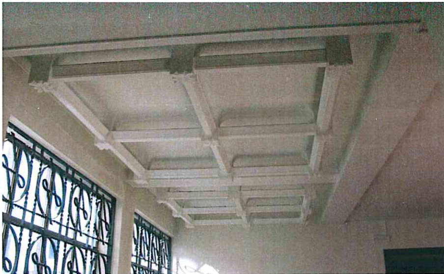
Fotografia 2 Klatka schodowa B - oprawa architektoniczna świetlówkowa - belka
