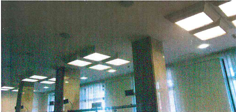
Fotografia 1 Recepcja - oprawa architektoniczna świetlówkowa 4x kwadrat
