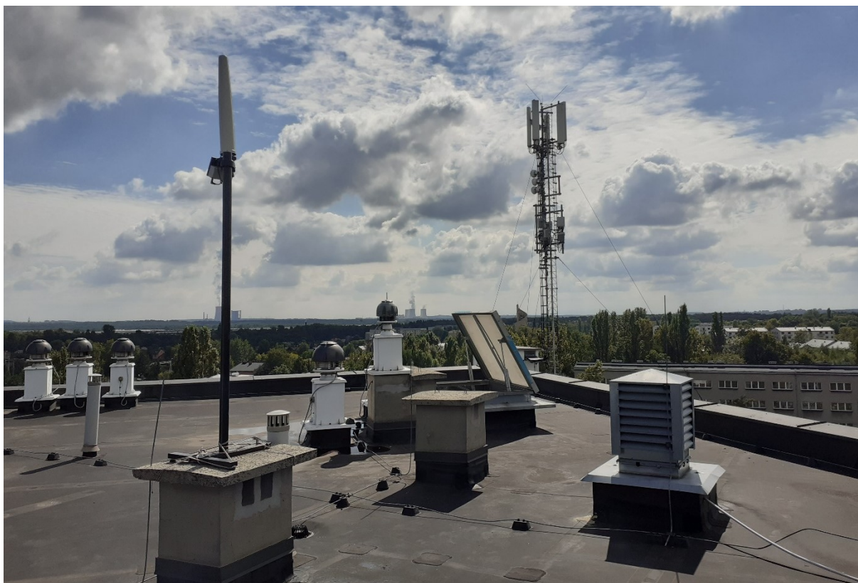
Rys. 2 Miejsce montażu SMS PEM – Śląski Uniwersytet Medyczny – widok na SBTK
