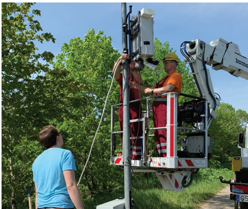
Fot. 1. Montaż opracowanego inteligentnego znaku przy drodze
