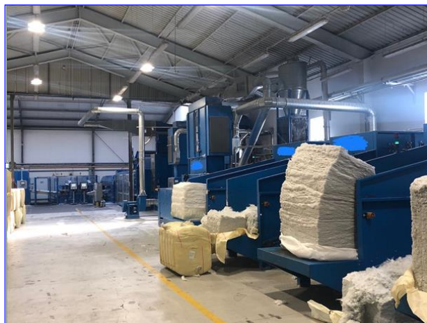
Fot. Linia zasilająca, podająca włókno do ciągu produkcyjnego w Zakładzie produkcyjnym MARTPOL w Niegosławicach (nadesłano z zakładu)
