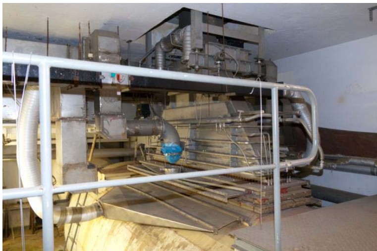
Rys. 4.15. Akcelerator służący do oczyszczania spalin
