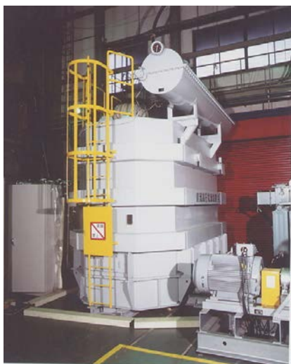
Rys. 9.12. Widok ogólny zasilacza wysokiego napięcia DC (EPST-800-102)
