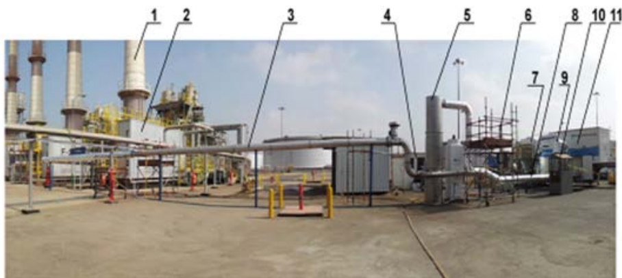
Rys. 4.17. Widok na instalację do oczyszczania gazów w Rafinerii Jedahh w Arabii Saudyjskiej: 1 – komin kotła F 1001, 2 – kocioł F 1001, 3 – rurociąg, 4 – sterownia, 5 – nawilżanie, 6 – komin instalacji pilotowej, 7 – filtr workowy, 8 – izolowany fragment rurociągu, 9 – cyklon, 10 – przechowywanie i podawanie amoniaku, 11 – mobilny akcelerator elektronów
