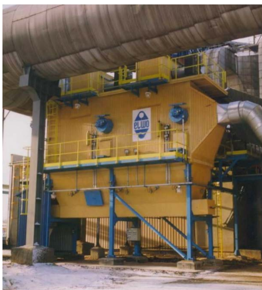
Rys. 9.10. Widok filtru elektrostatycznego instalacji pilotowej oczyszczania gazów odlotowych zbudowanej w Elektrociepłowni Kawęczyn
