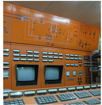
Fot. 10. Sterownia SBM EJ (fot. Łukasz Sawicki)
