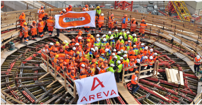
Fot. 28. Zabetonowano ostatni fragment wewnętrznej kopuły: na zdjęciu robotnicy Bouygues i Freyssinet oraz nadzór Areva. Toast wznoszony wodą sodową (fot. Zbigniew Wiegner)
