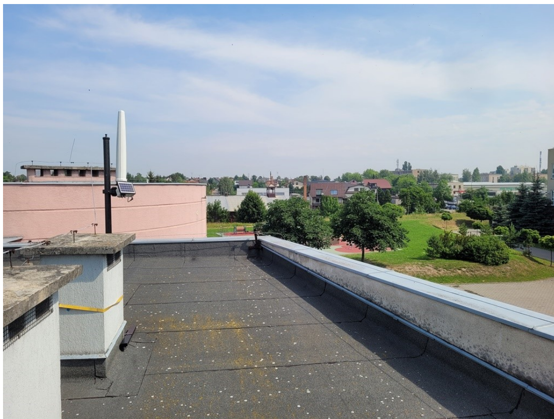
Rys. 3 Miejsce montażu SMS PEM – Szkoła Podstawowa nr 2 w Piotrkowie Trybunalskim – widok na SBTK
