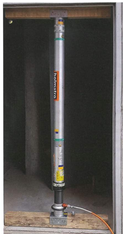
Fot. 1. Stabilizacja podporą typu T. Podciąg i podwalina z drewnianych kantówek, słup z ratowniczego systemu stabilizacji
