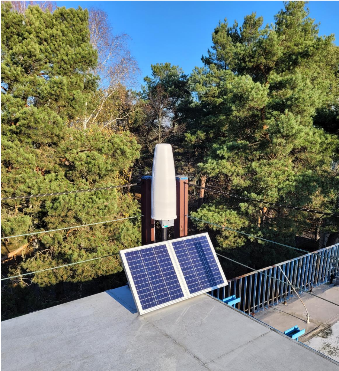
Rys. 2 Miejsce montażu SELMS PEM – IŁ-PIB w Warszawie
