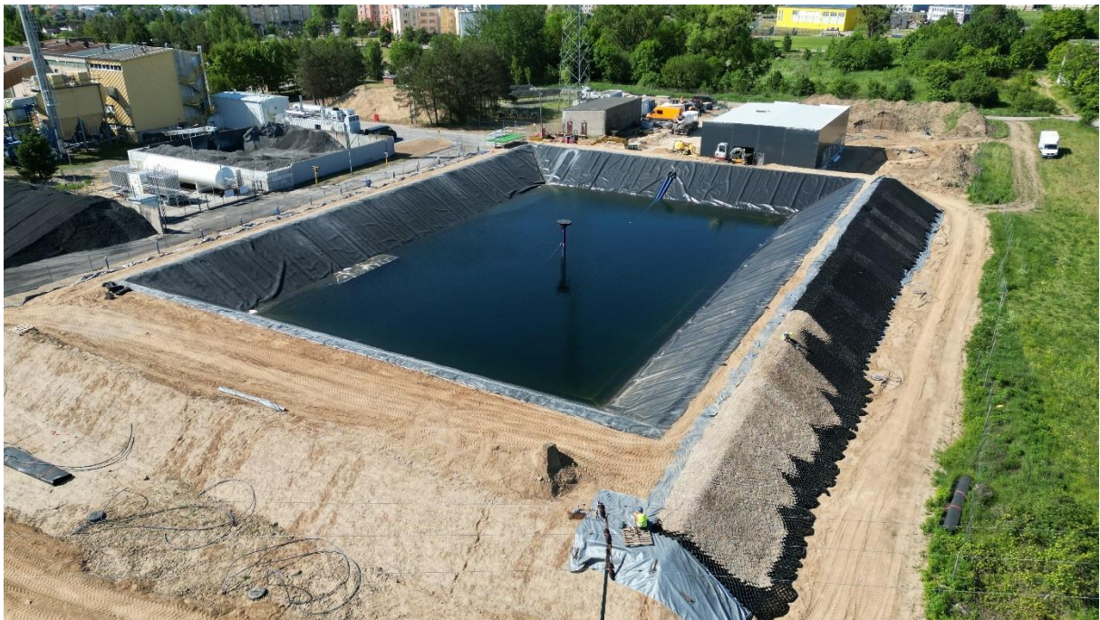
Rysunek 29. Wykańczanie i zabezpieczanie wałów basenu. Napełnianie wodą z sieci wodociągowej. Maj 2023.
