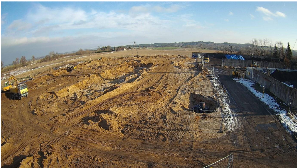
Rysunek 19. Początek prac nad wodnym magazynem ciepła, stan po wykonaniu prac związanych z gruntowym magazynem ciepła. Luty 2023.
