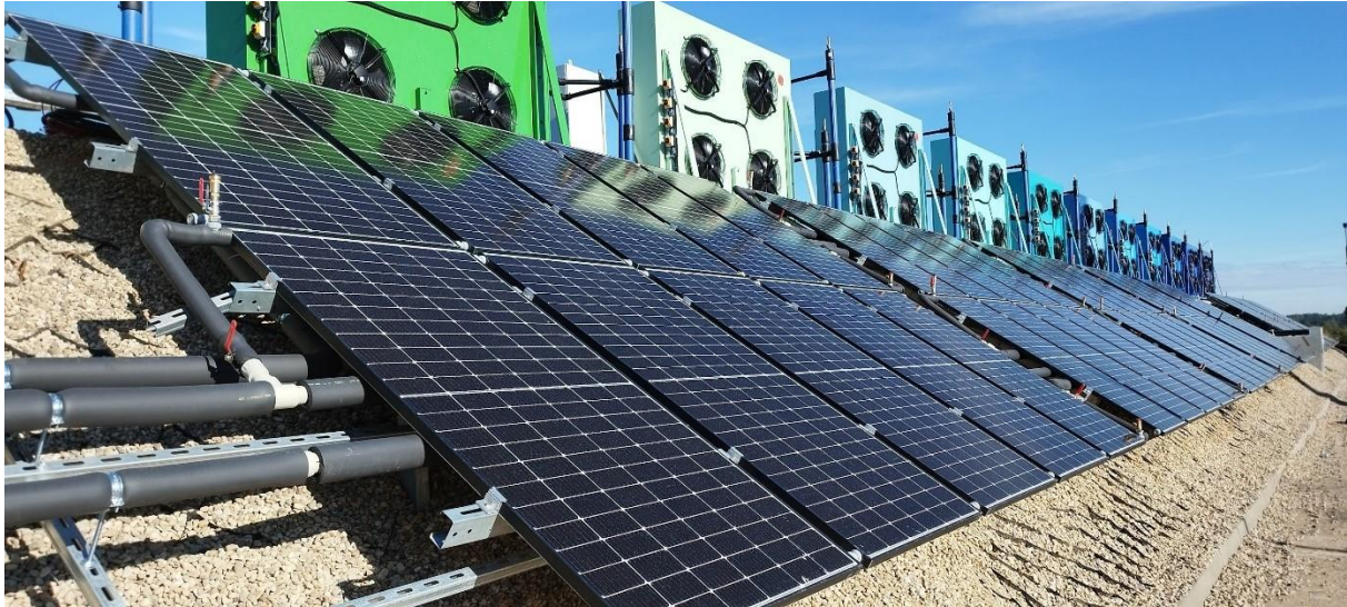
Rysunek 48. Hybrydowe kolektory słoneczne zainstalowane na wale wodnego magazynu ciepła.
