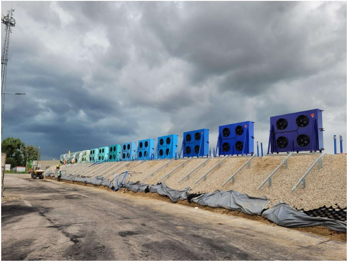
Rysunek 46. Powietrzne wymienniki ciepła zainstalowane na wale wodnego magazynu ciepła PTES.
