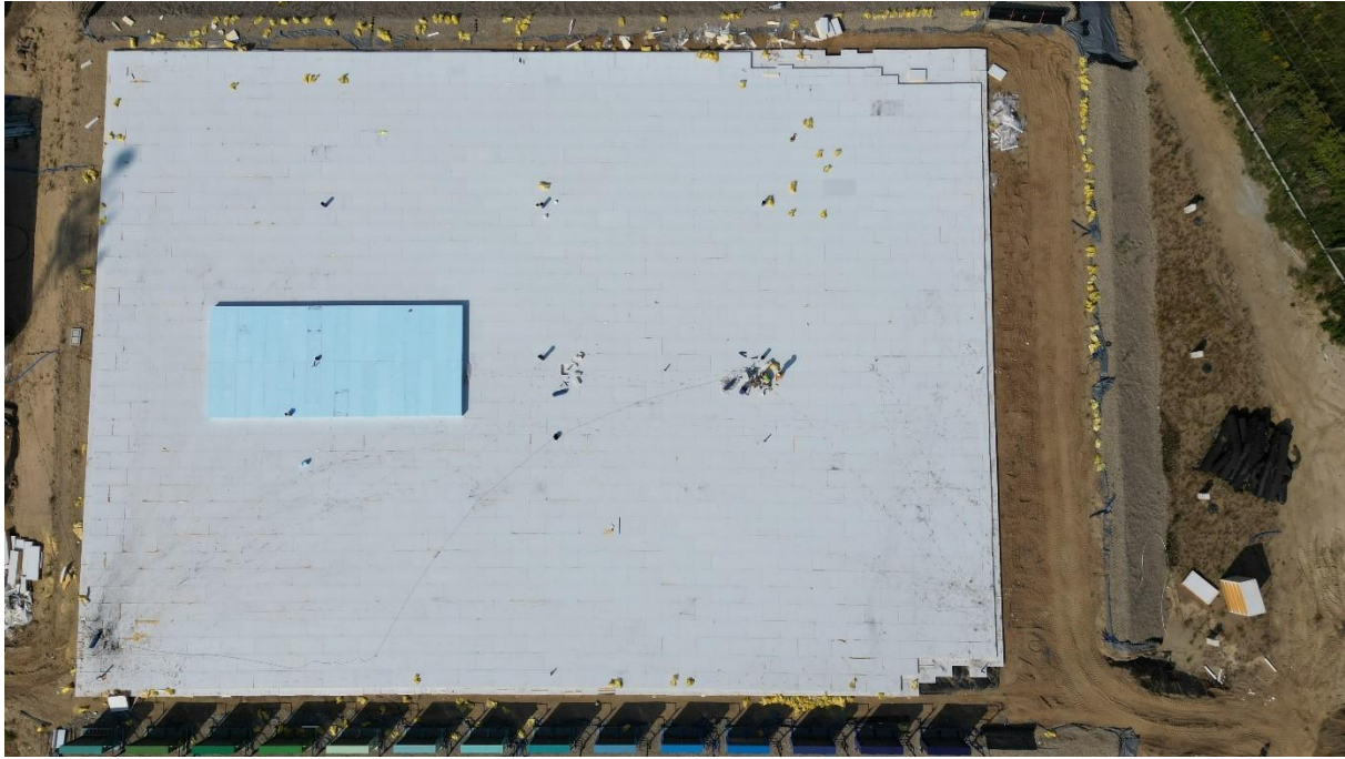
Rysunek 36. Izolacja termiczna na powierzchni basenu.
