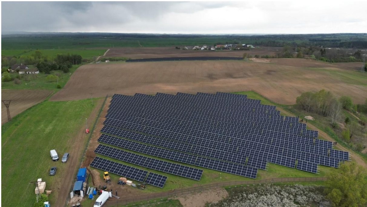
Rysunek 55. Zamontowane moduły PV.
