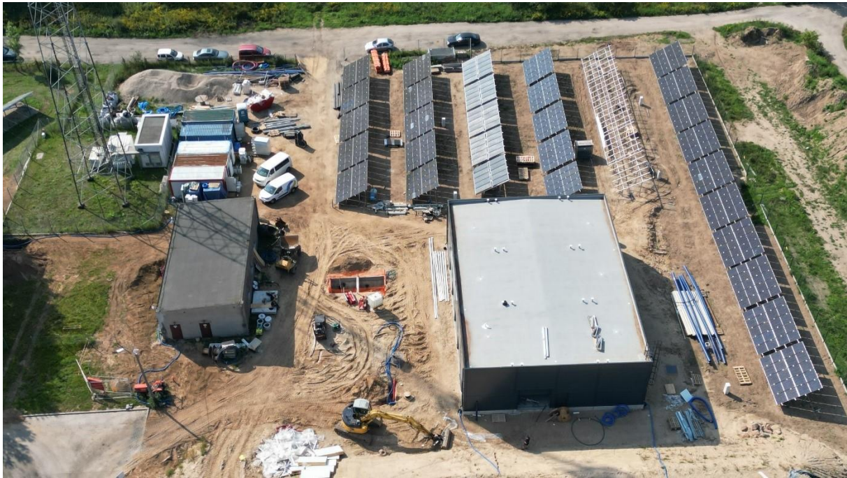
Rysunek 50. Widok na instalację pilotażową kolektorów hybrydowych PVT.
