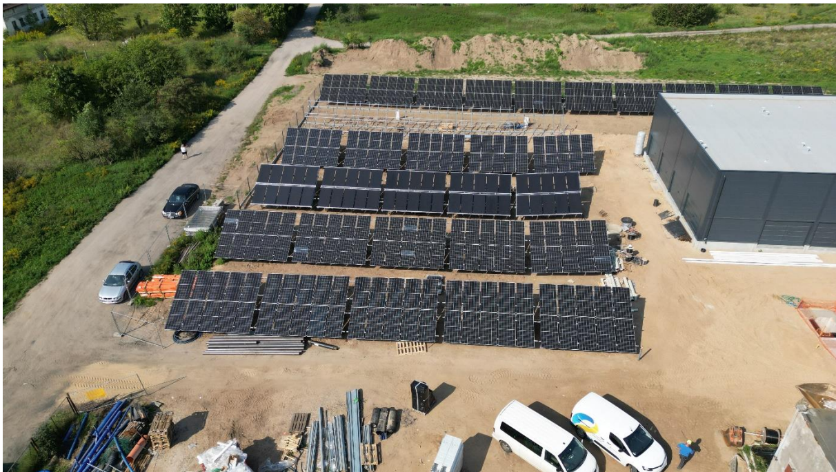
Rysunek 49. Pilotażowa instalacja pozyskiwania energii ze słońca złożona z hybrydowych kolektorów słonecznych w dwóch wariantach, klasycznych kolektorów słonecznych oraz modułów PV wykorzystanych w konstrukcji kolektorów PVT.
