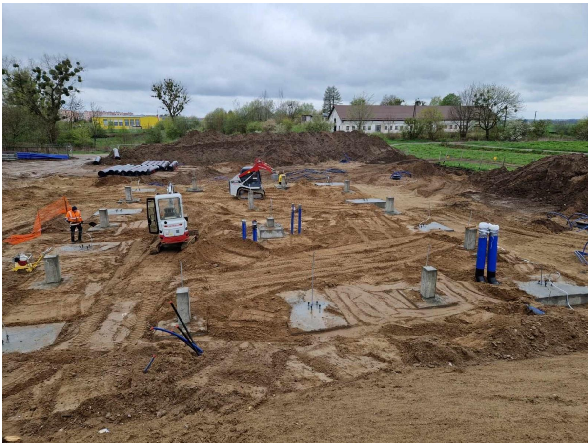
Rysunek 40. Fundamenty maszynowni pomp ciepła, widoczne wyjścia rurociągów wprowadzanych od dołu do maszynowni. Kwiecień 2023.
