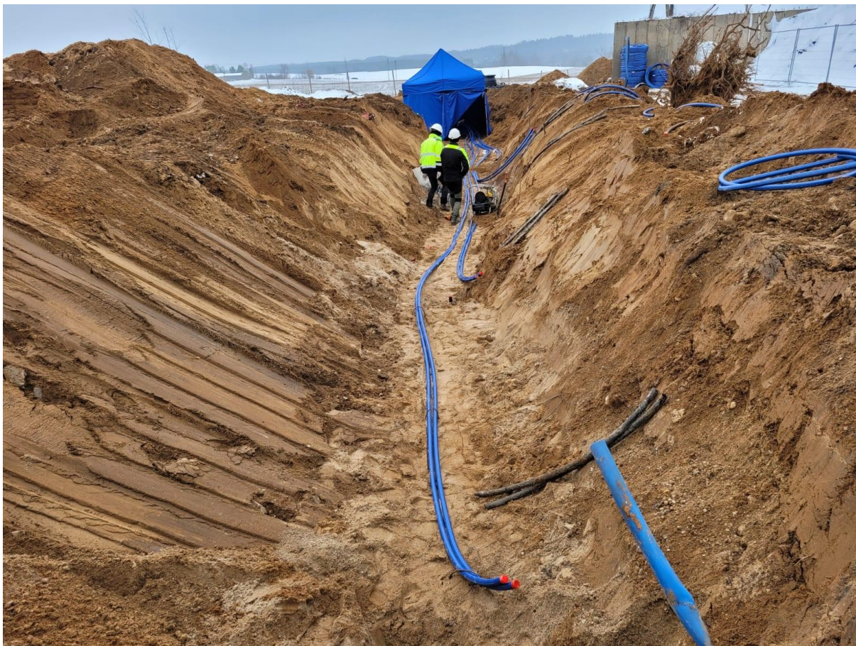
Rysunek 13. Montaż połączeń poziomych w warunkach zimowych, W tyle ogrzewany namiot. Styczeń 2023.
