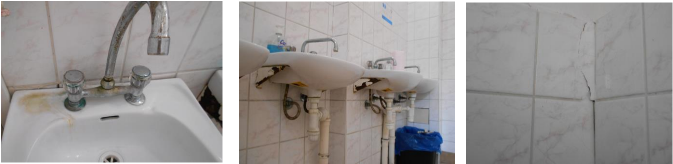
Rys. 8, 9, 10 Niewłaściwy stan sanitarno – higieniczny i techniczny płytek na ścianach w kabinach ustępowych (pęknięcie płytek z ostrą krawędzią) oraz umywalk, kranów i instalacji (korozja, zabrudzenia, odwarstwienie farby) w sanitariacie
