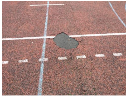
Rys. 11 Niewłaściwy stan techniczny nawierzchni płyty boiska (pęknięcia, ubytki)
