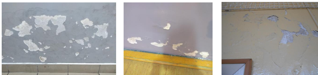
Rys. 5, 6, 7 Niewłaściwy stan sanitarno – higieniczny i techniczny ścian na salach sportowych i bloku sportowym (ślady odpadającego tynku i farby oraz odwarstwienia wskazujące na dużą wilgotność muru, liczne elementy łuszczenia farby).
