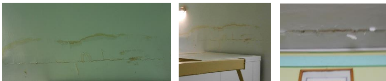
Rys. 2, 3, 4 Niewłaściwy stan sanitarno – higieniczny i techniczny sufitów w salach zajęć oraz holu (mokre przecieki, odpryski farby).
