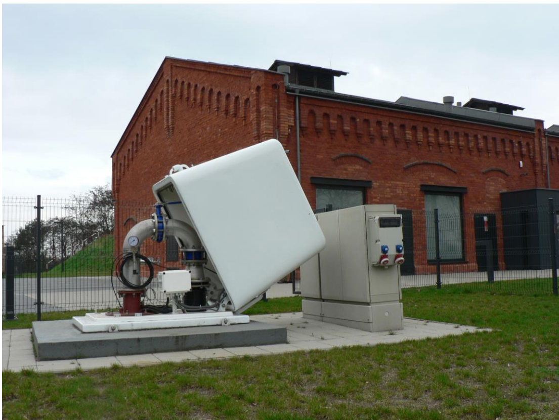
Rys. 1. Studnia głębinowa – Stacja Uzdatniania Wody w Zaborowie (wodociąg publiczny Leszno)
