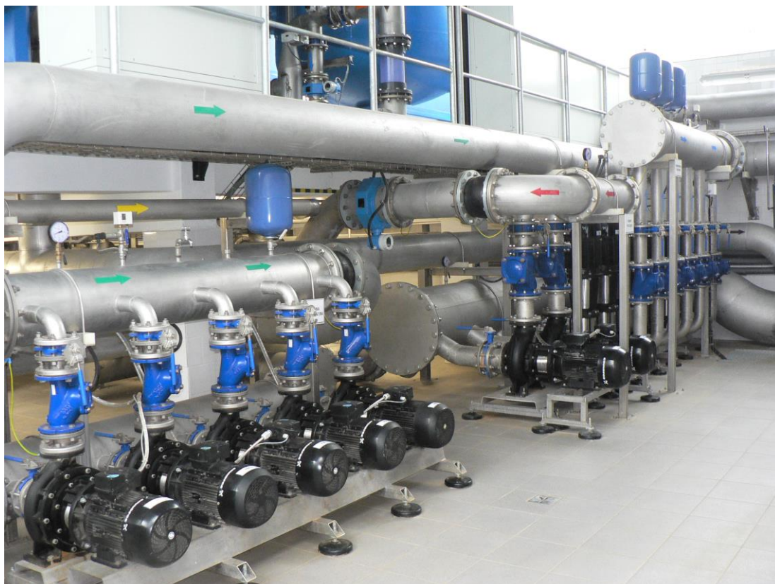
Rys. 9. Stacja Uzdatniania Wody w Zaborowie (wodociąg publiczny Leszno) – pompy międzyoperacyjne, do płukania filtrów i sieciowe
