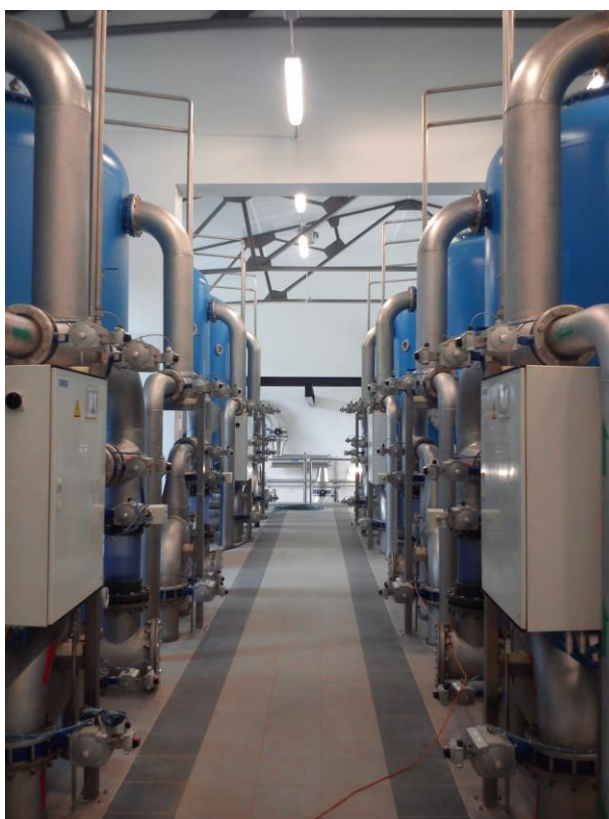
Rys. 8. Stacja Uzdatniania Wody w Zaborowie (wodociąg publiczny Leszno) – hala filtrów
