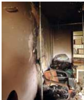
Miejsce pożaru w mieszkaniu doszczelnionym po wykonaniu pierwszego testu
