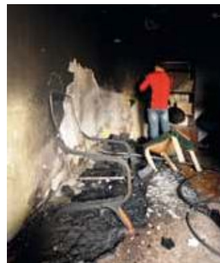
Miejsce pożaru w mieszkaniu doszczelnionym po wykonaniu drugiego testu
