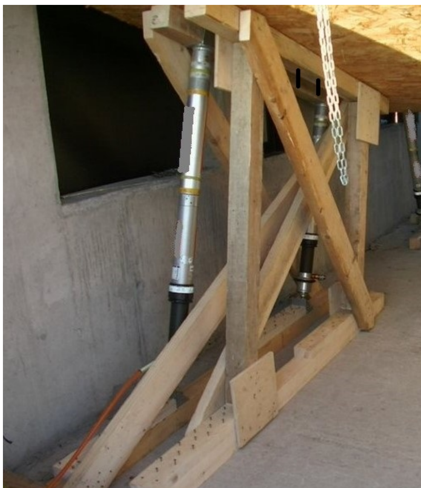
Fot. 63. Podpora zabezpieczająca strop pochyły, zakotwiony – klasy 2
