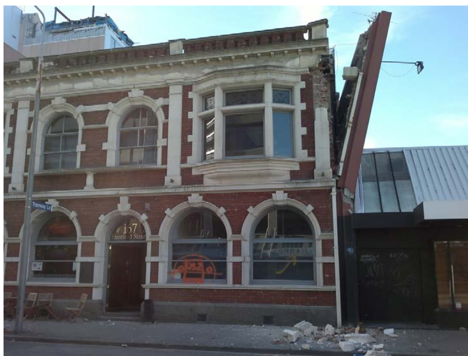
Fot 5. Zawalenie typu „90 stopni” (pełnej ściany)
