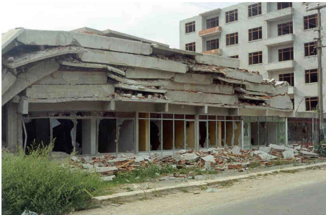
Fot. 3. Zawalenie typu „sandwich” (kanapka)
