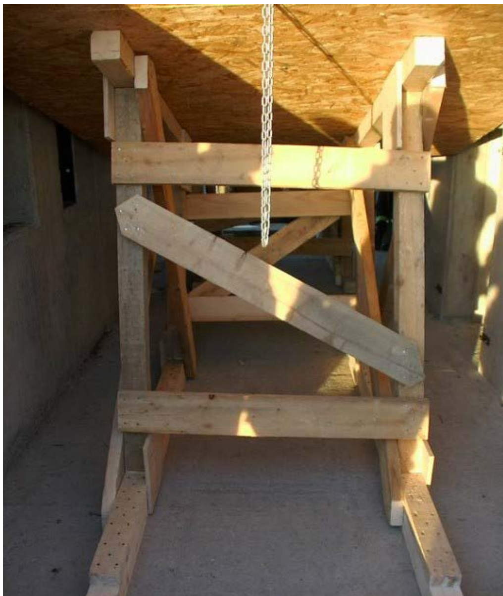
Fot. 64. Podpora zabezpieczająca strop pochyły, zakotwiony klasy 3
