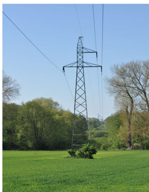
Fotografia 3.2. Linia wysokiego napięcia województwo zachodniopomorskie (źródło: GIOŚ)
