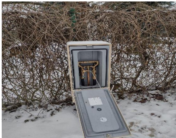
Szafka do pobierania próbek wody bezpośrednio z sieci wodociągowej. Punkt poboru zamontowany w Łęgowie na sieci wodociągu publicznego Kłępsk, Źródło: fot. PSSE Zielona Góra
