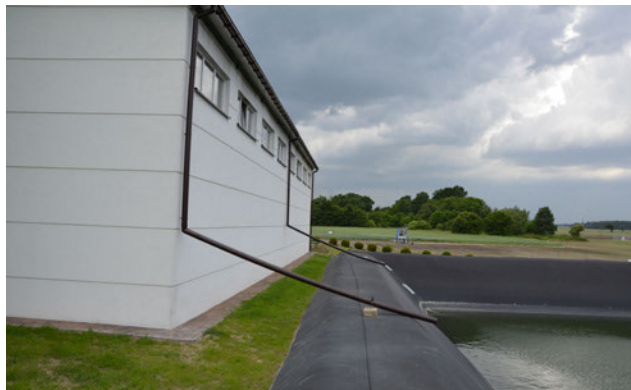
Fot. 13. Odbiór wody deszczowej z dachu budynku gospodarczego. (W. Treder)
