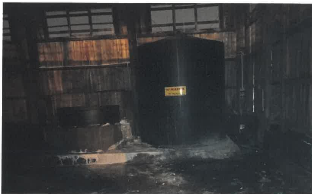
6. Wytwornica soli do demontażu.
