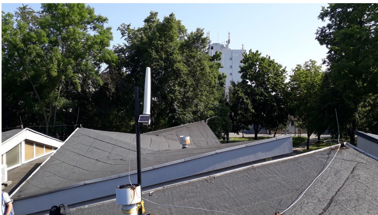
Rys. 4 Miejsce montażu SMS PEM – Szkoła Podstawowa nr 1 w Płocku – widok na SBTK
