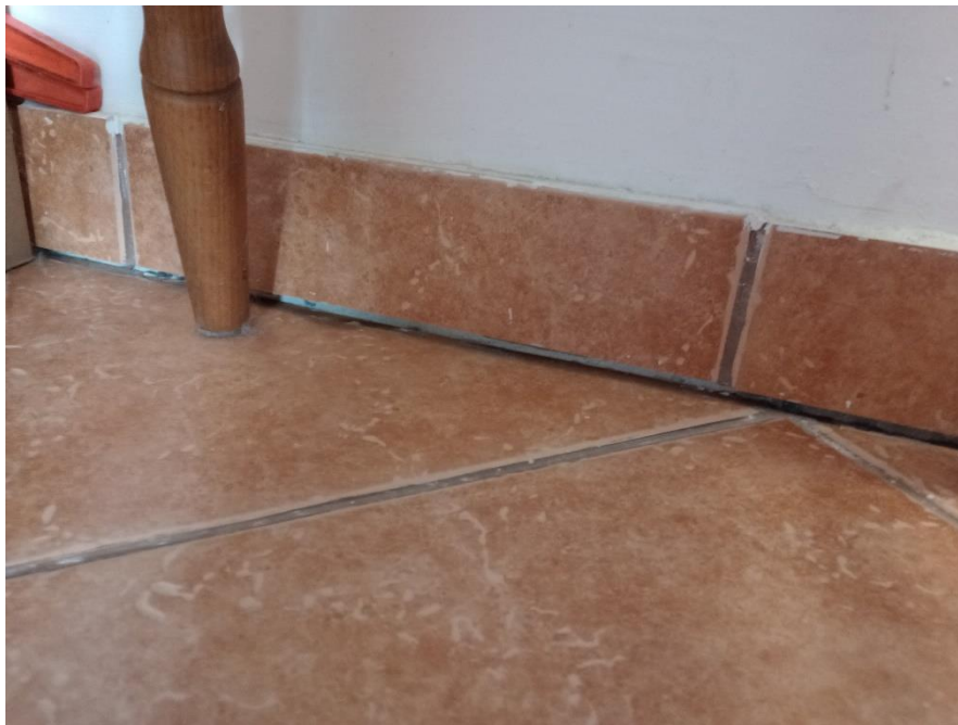
Fot. 9 Pomieszczenia kancelarii Krajewo – pomieszczenie biurowe – ubytki fugi
