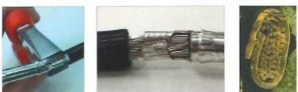
Rys. 2b. Nieodpowiednie szczypce do zaciskania, źle wykonany zacisk: dostęp powietrza do żyły przewodu, możliwa korozja, wytrzyma siłę rozciągającą tylko 94 N, ryzyko powstania łuku elektrycznego, porażenia prądem lub pożaru
