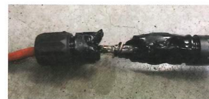
Rys. 3. Spalona niezgodna para złączy
