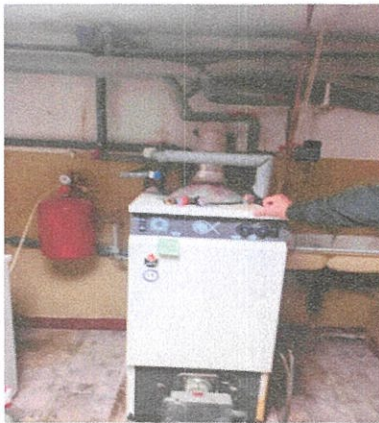
Kotłownia na poziomie piwnicy w lokalu Nr 1
