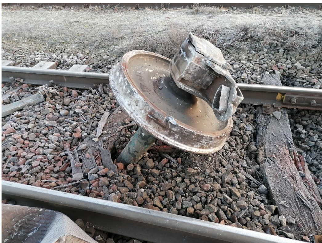
Zdjęcie 2 - Widok jednej części złamanej osi (źródło: materiały przekazane przez komisję kolejową)
