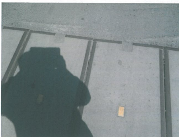
Fot. 16. Widoczne ślady na przejeździe
