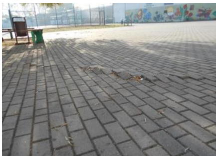
Rys. 3 Niewłaściwy stan techniczny powierzchni placu rekreacyjnego
