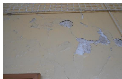
Rys. 7 Niewłaściwy stan sanitarno-higieniczny i techniczny ścian na sali rekreacyjno-zastępczej
