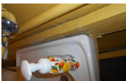
Rys. 6 Niewłaściwy stan sanitarno-higieniczny i techniczny deski przyściennej oraz ruchome umywalki
