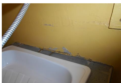
Rys. 5 Niewłaściwy stan sanitarno-higieniczny i techniczny ściany w sanitariacie
