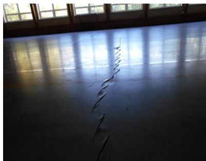
Rys. 2 Niewłaściwy stan techniczny powierzchni sali gimnastycznej
