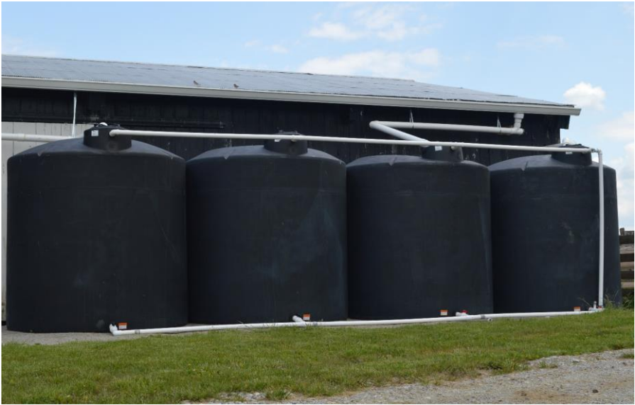
Fot. 42. Zbiorniki do magazynowania wody deszczowej z powierzchni dachu obory
