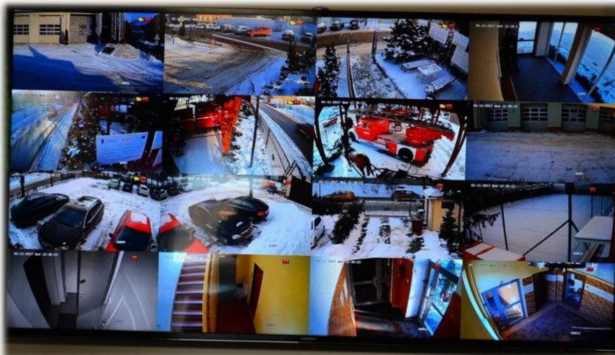
Fot. 31 Monitor systemu zainstalowany na SKKW PSP w Gdańsku.
