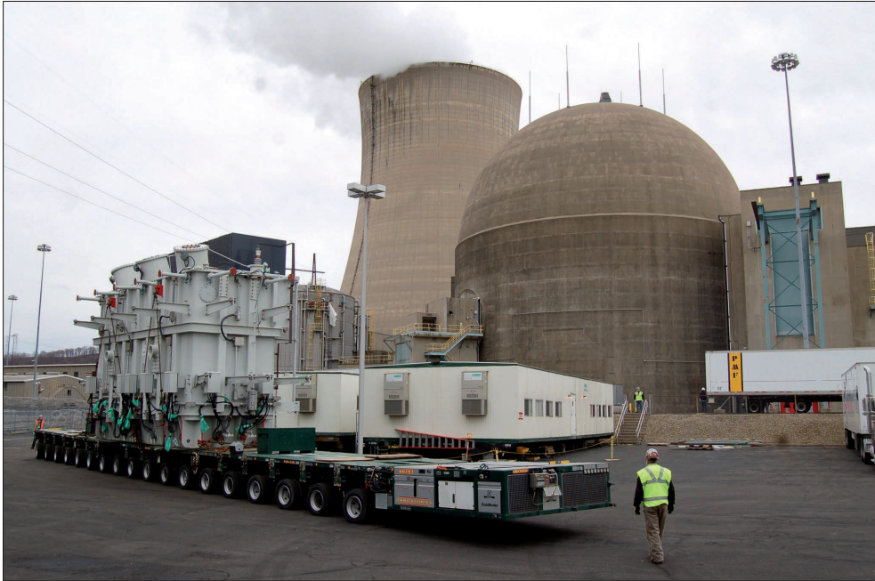
Rysunek 22. Wymiana transformatora mocy w Elektrowni Jądrowej Beaver Valley w Pensylwanii [First Energy Nuclear Operating Co.]
