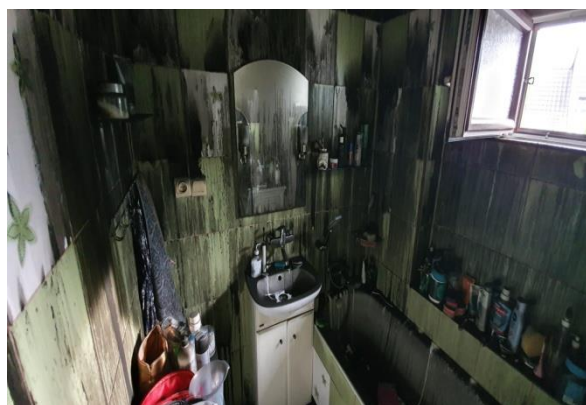
Fot. 22. Pożar budynku jednorodzinnego
