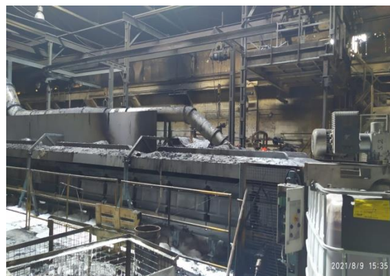
Fot. 21. Pożar w Odlewni Źeliwa
