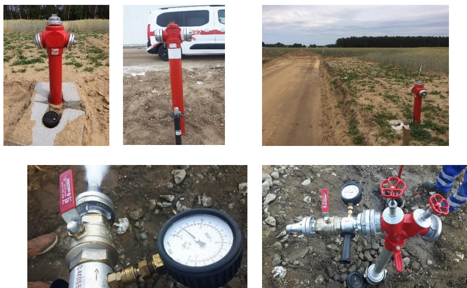
Fot. 74. Sieć wodociągowa przeciwpożarowa z hydrantami zewnętrznymi przeciwpożarowymi
