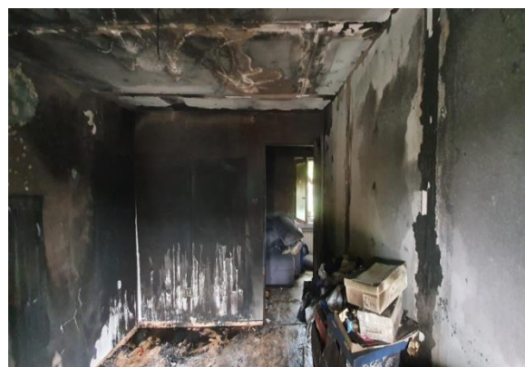
Fot. 23. Pożar budynku jednorodzinnego
