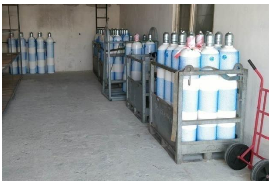
Fot. 58. Bank tlenu w Trzciance
