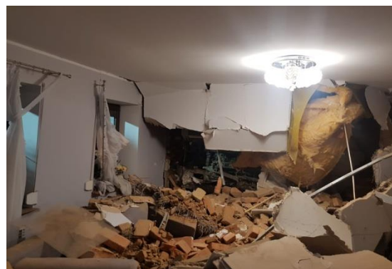
Fot. 41. Samochód ciężarowy wjechał w budynek mieszkalny
