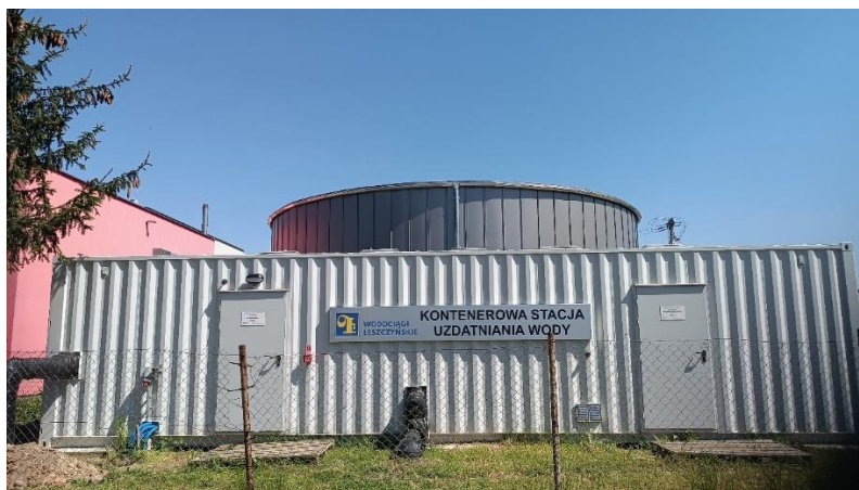
Zdjęcie n1 1: Kontenerowa stacja uzdatniania wody w Lipnie.
