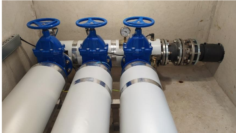
Zdjęcie nr 3: 3 pompy głębinowe w podziemnej komorze na sieci wodociągowej (Wodociąg Radomicko)
