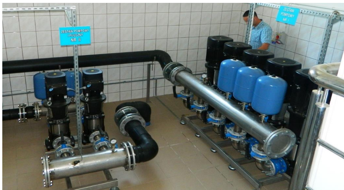
Fot. 7. Stacja Uzdatniania Wody w Jasionce - zestaw pomp.
