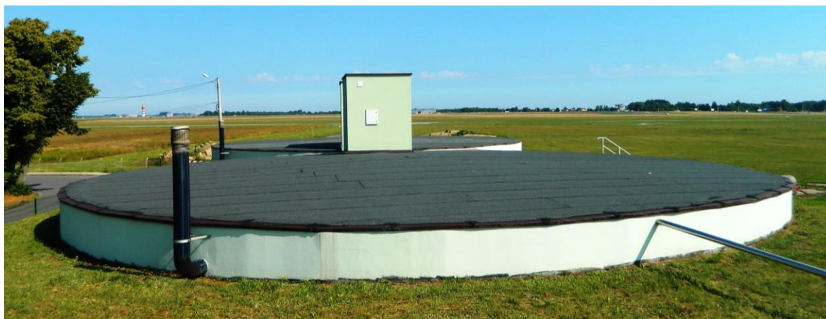
Fot. 6. Stacja Uzdatniania Wody w Jasionce – zbiorniki.
