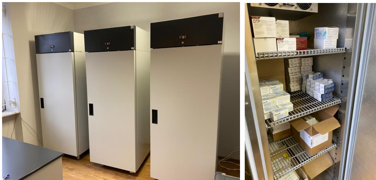
Fot. 2. Urządzenia chłodnicze w Magazynie Szczepionek Powiatowej Stacji Sanitarno-Epidemiologicznej w Rzeszowie.
