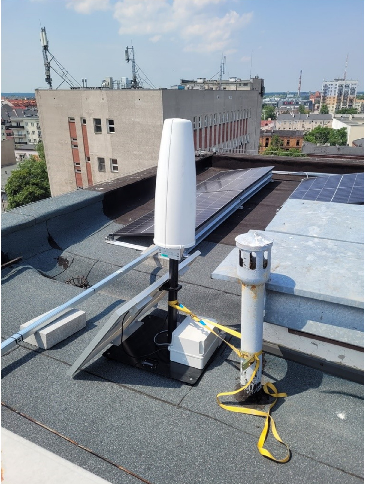
Rys. 3 Miejsce montażu SELMS PEM – UM Włocławek – widok na stacje bazowe
