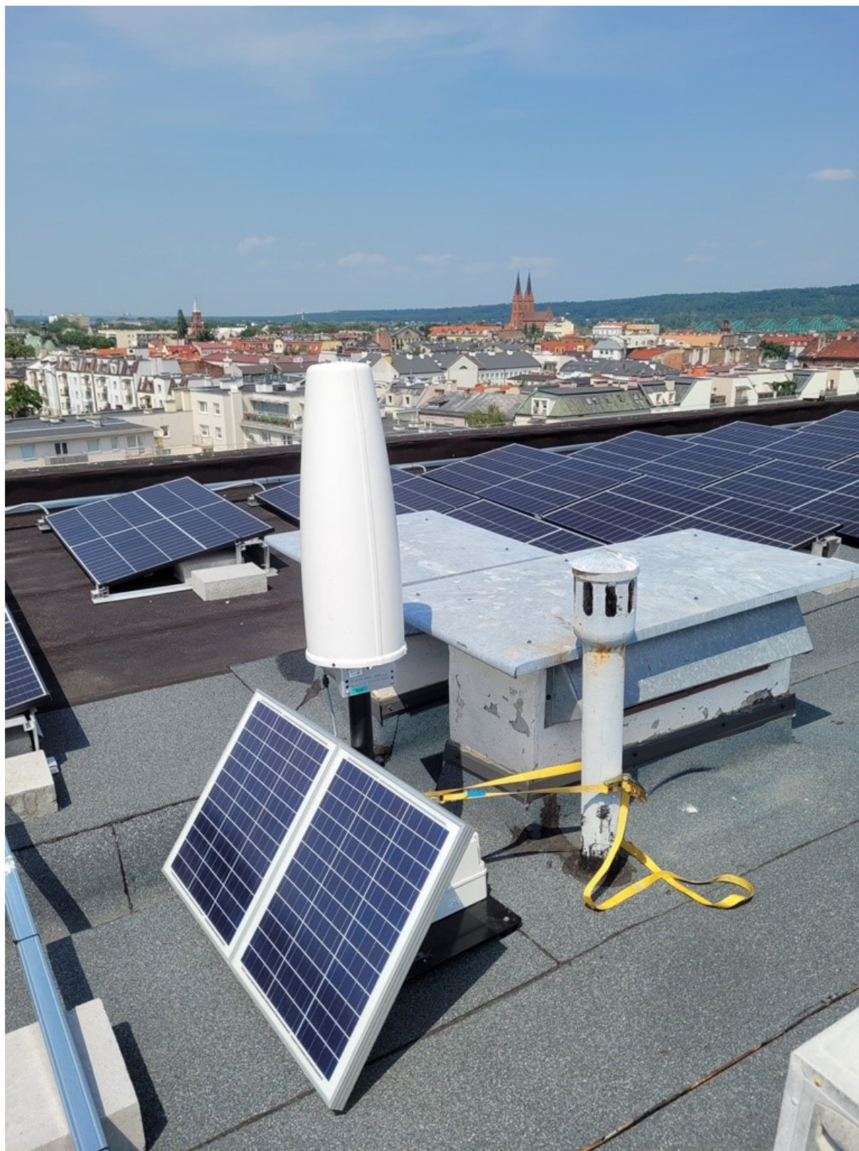
Rys. 2 Miejsce montażu SELMS PEM – dach UM Włocławek
