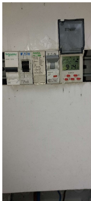
Szafka oświetleniowa parking Gwiazdzin
