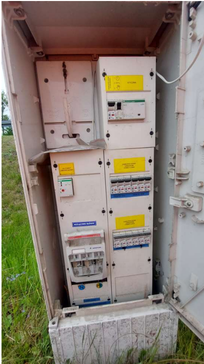
Szafka oświetleniowa skrzyżowanie Nieżywieć
