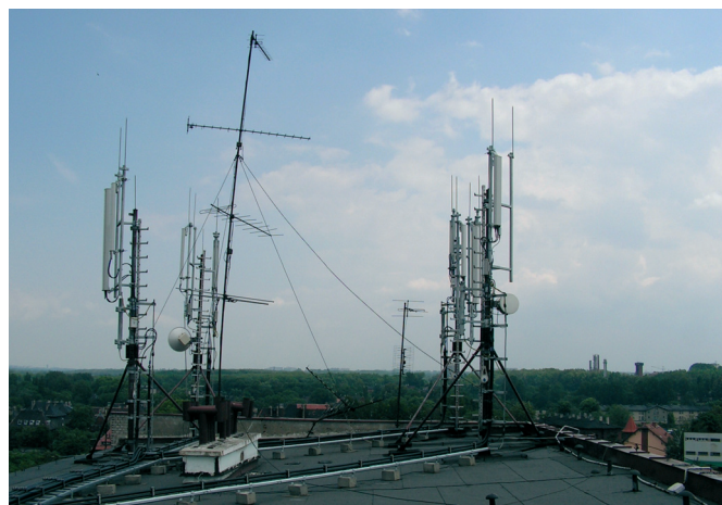
Fot. 6. Stacja bazowa telefonii komórkowej (archiwum WIOŚ)
