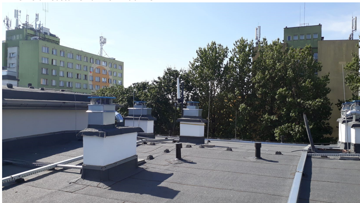
Rys. 2 Miejsce montażu SMS PEM – Szkoła Podstawowa nr 6 w Lublinie – widok na SBTk
