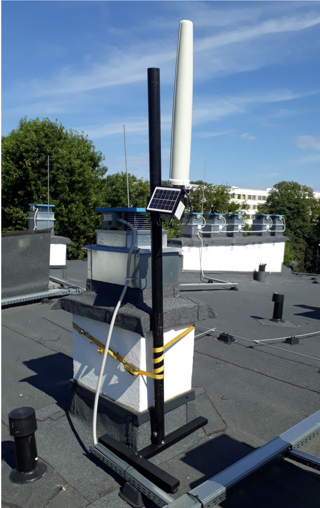
Rys. 3 Miejsce montażu SMS PEM – Szkoła Podstawowa nr 6 w Lublinie
