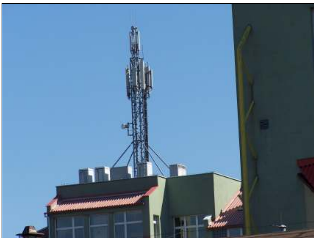
Fot. 3. Fragment instalacji radiokomunikacyjnej na budynku przy ul Oświęcimskiej
