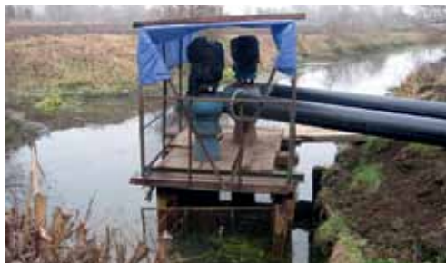
Stacja pomp na Żuławach. Fot. ZMIUWWP Gdańsk
