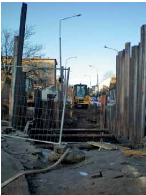
Miasto czeka jeszcze naprawa zniszczeń nawierzchni.
