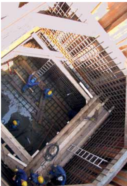
Komora wylotowa. Fot. UM Sopot
