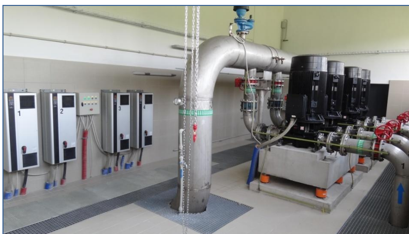
Fotografia 1 Grzybowice [źródło: http://www.wodociagi.zabrze.pl/index.php/obiekty/wydzial-produkcji-wody/stacja-uzdatniania-wody/stacja-uzdatniania-wody-Grzybowice ]
