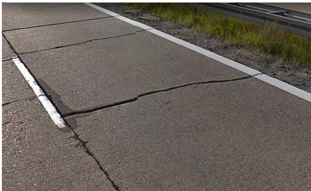
Rys. 6.4. Zidentyfikowane uszkodzenia szczelin (autostrada A18, pas prawy, jezdnia południowa)
