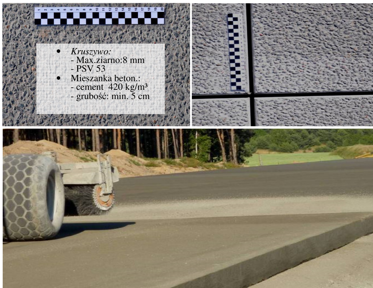
Rys. 2.17. Przykład nawierzchni w technologii odkrytego kruszywa realizowanej na autostradzie A2 w Polsce
