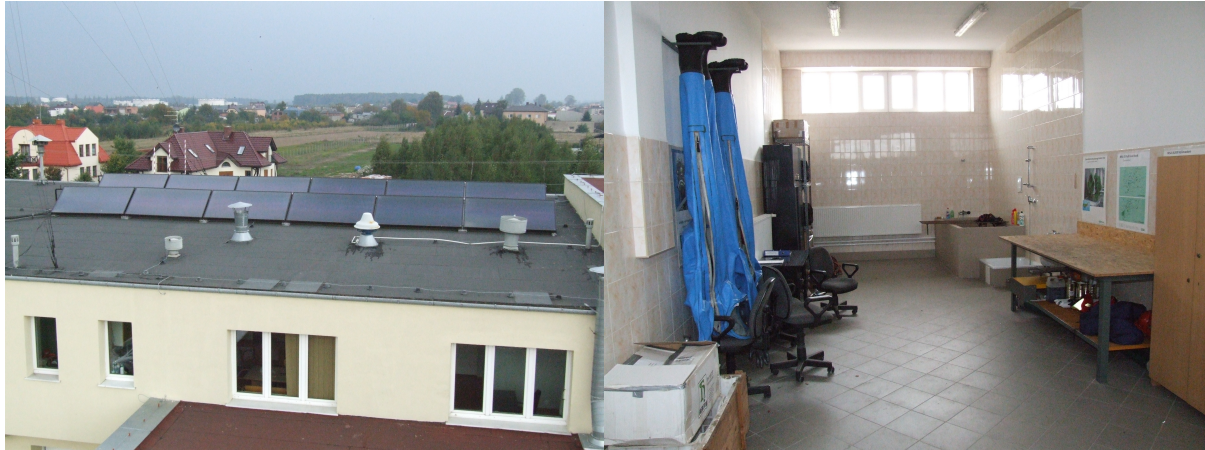
Instalacja baterii słonecznych wykorzystywana do podgrzewania wody użytkowej i Stacja P-Gaz Dym
